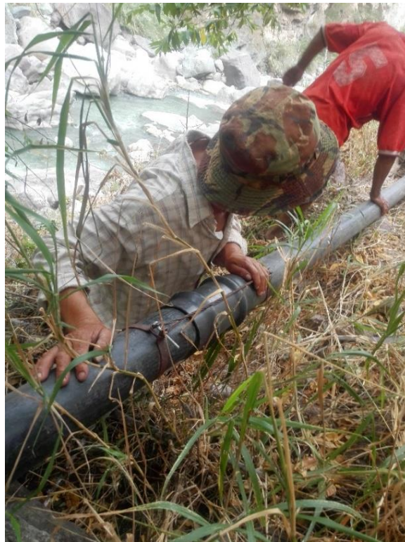
Figura 20: Tubería de conducción
