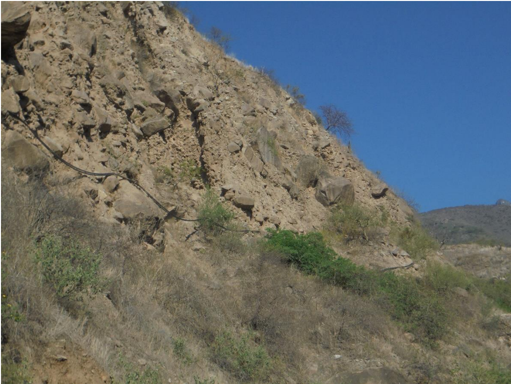
Figura 42: Tubería de conducción en peñascos km 1.4
