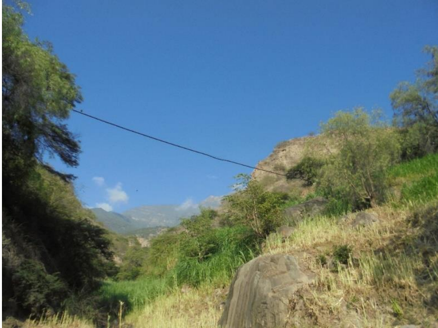
Figura 21: Pase aéreo en un tramo de la tubería de conducción
