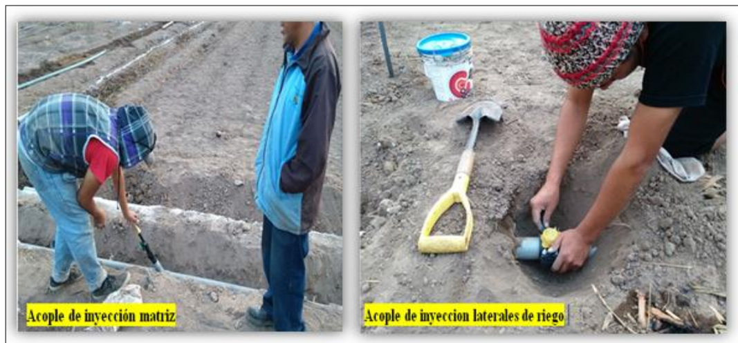
Figura 20: Instalación de válvula de acople para fertirrigación
