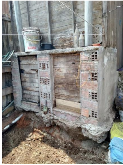
Figura 28: Cámaras de baños fijos
