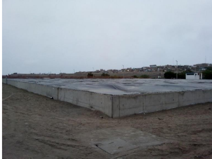
Figura 13: Laguna anaerobia de la PTAR Huáscar
