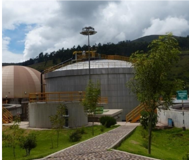
Figura 24: Digestor anaerobio de la PTAR San Jerónimo
