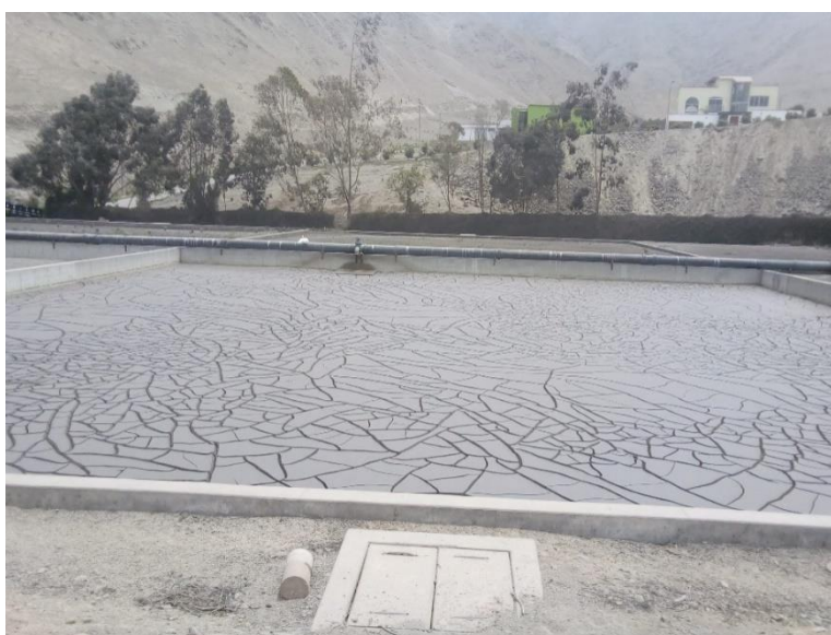
Figura 18: Lechos de secado de la PTAR Cieneguilla
