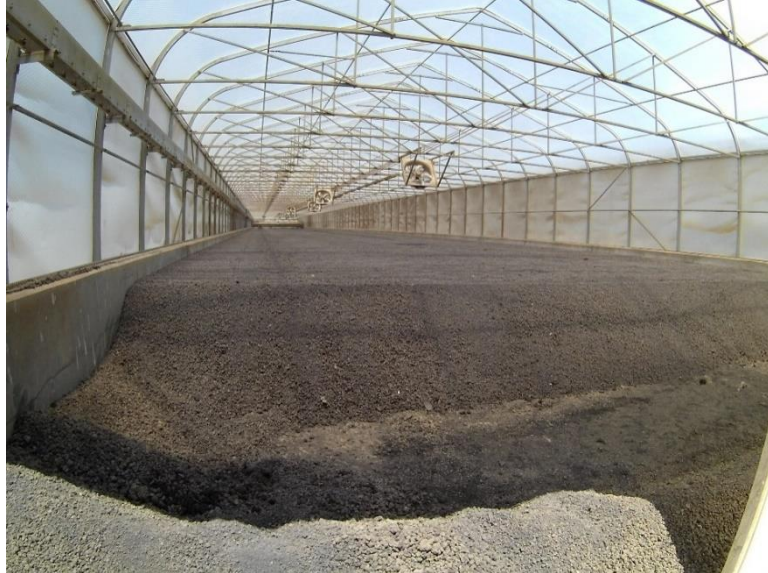
Figura 22: Secador térmico de la PTAR La Escalerilla
