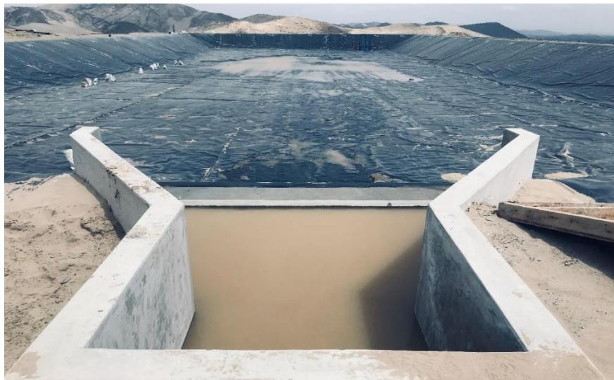
Figura 15: Cámara ahogada o rompe presión adyacente al reservorio
