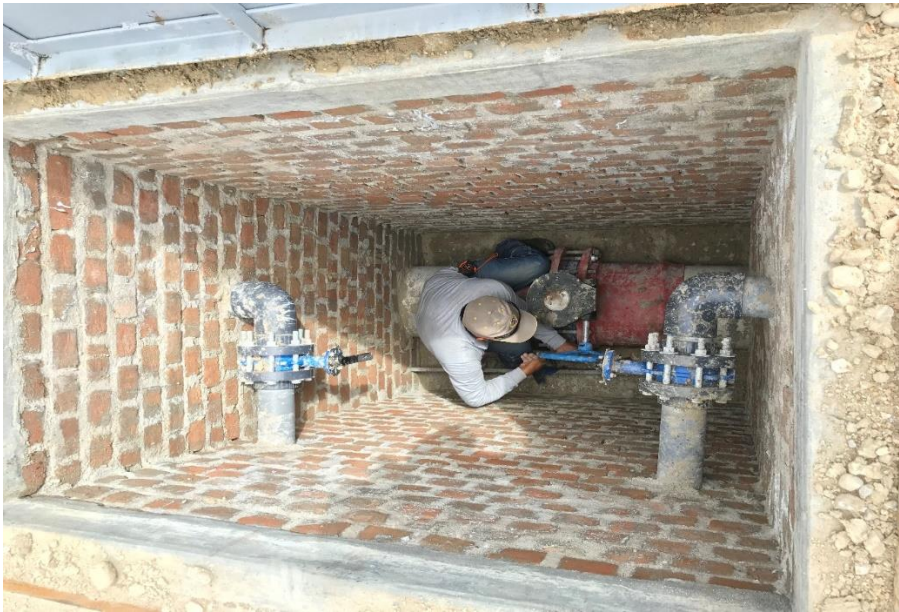
Figura 9: Válvulas mariposa de corte y evacuación para reparación y mantenimiento
