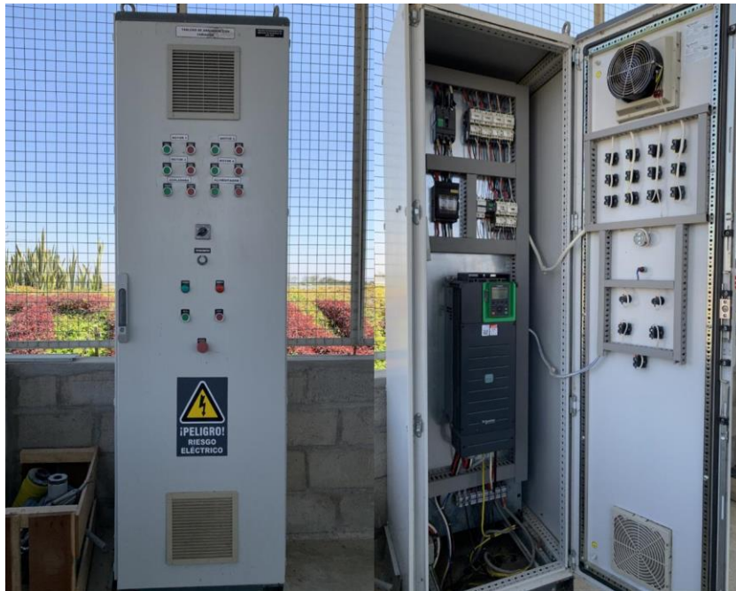
Figura 18: Tablero variador de velocidad de 50 HP
