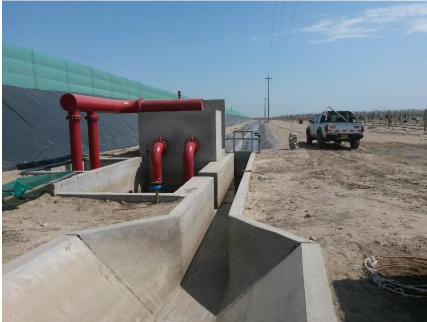
Figura 23: Sistema mixto de llenado del reservorio (gravedad/bombeo) Proyecto 9534 Fegurri 12 Llenado del reservorio (2015)
