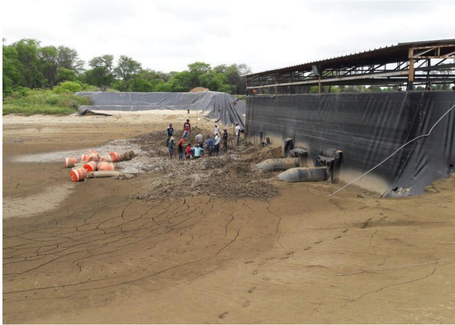
Figura 5: Obra de captación, estado después de la inundación causada por el río Piura durante el fenómeno de El Niño del 2017
