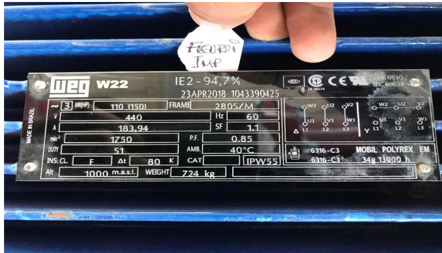
Figura 7: Placa de motor de 150 HP para electrobomba
