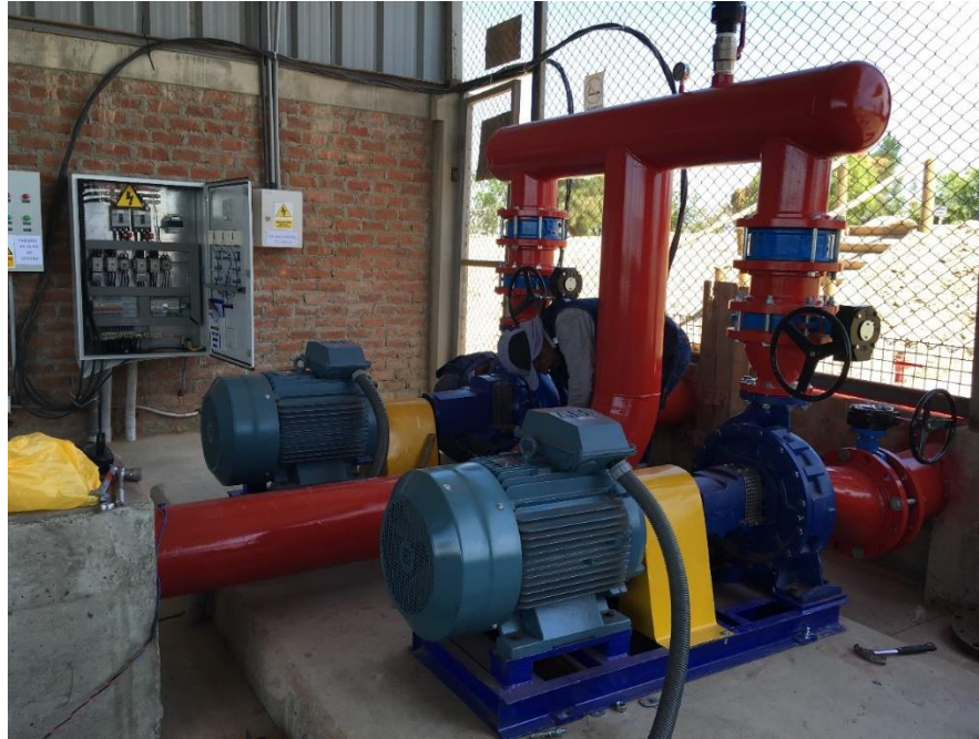
Figura 6: Equipo de bombeo con bombas en paralelo
