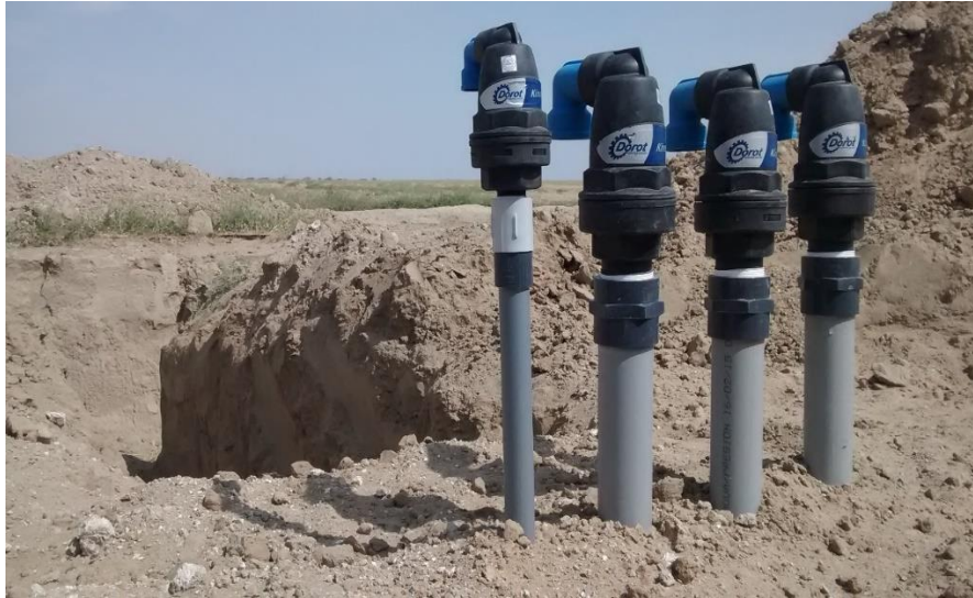
Figura 11: Válvulas de aire o ventosas
