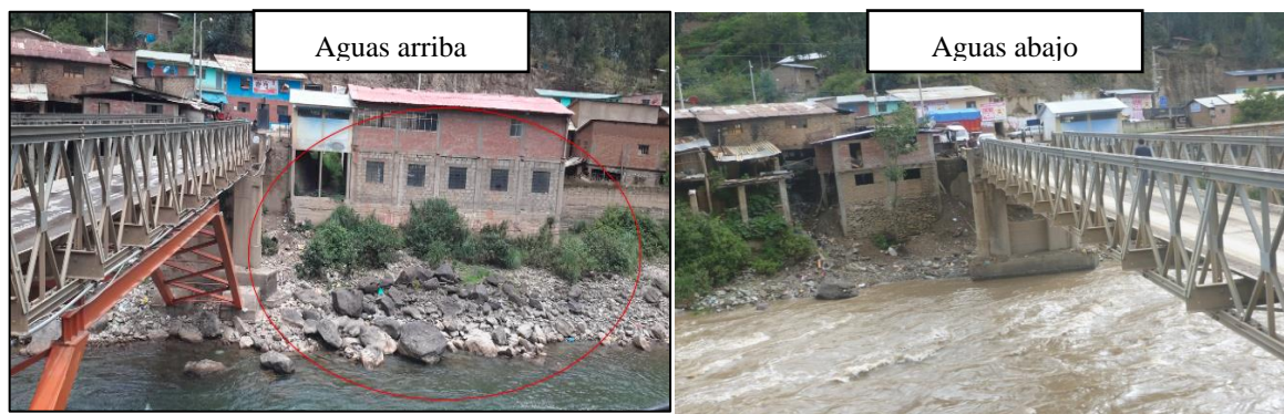
Figura 149: Zona crítica margen derecha del río marañón
