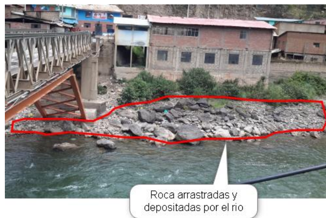
Figura 43: Vista fotográfica de las rocas arrastradas y depositadas en la margen derecha del río Marañón.
