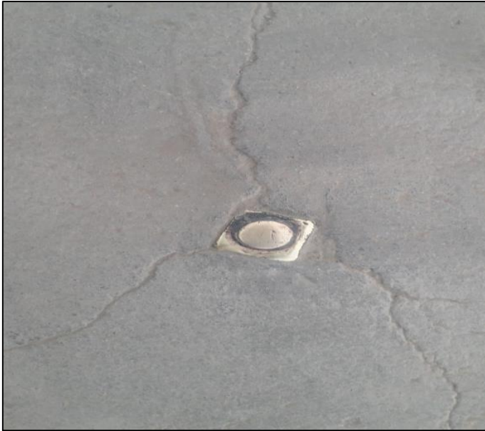
Figura N° 25: Vista del BM destruido con código BVP-7 ubicado en El Callao
