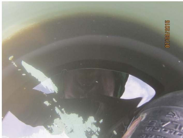
Figura 19: Tanque de almacenamiento de agua domiciliario, previo al proceso de limpieza y desinfección
