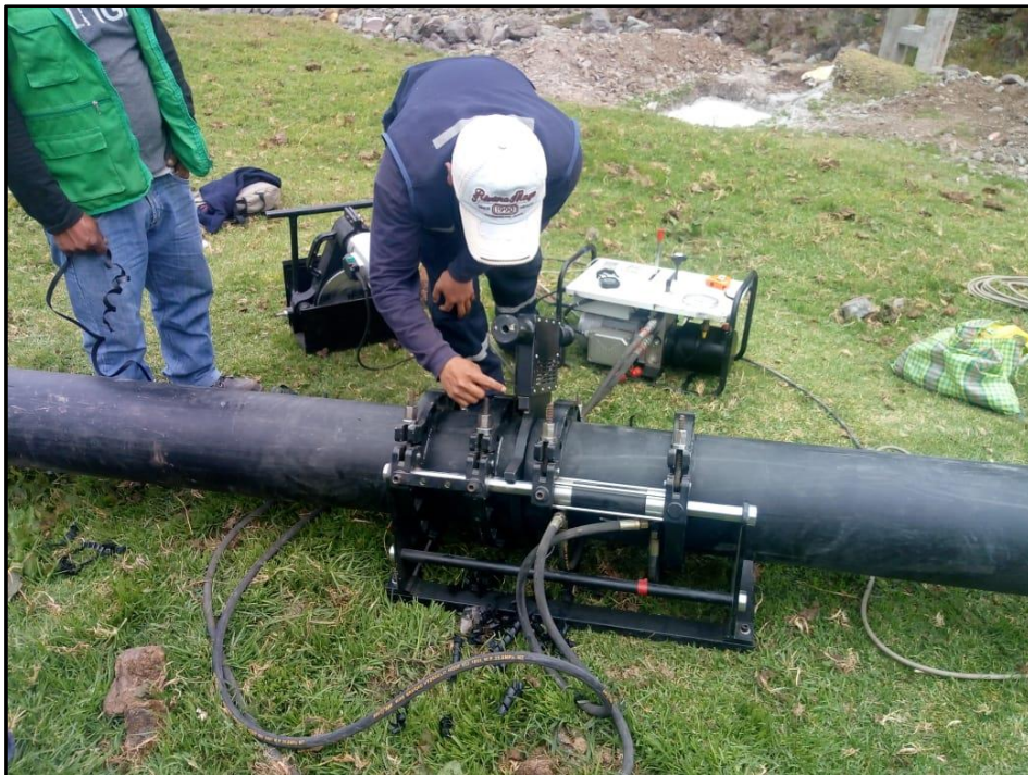
Figura 79: Termofusión de tubería hdpe de 250mm para el pase aéreo del canal Pisacwain
