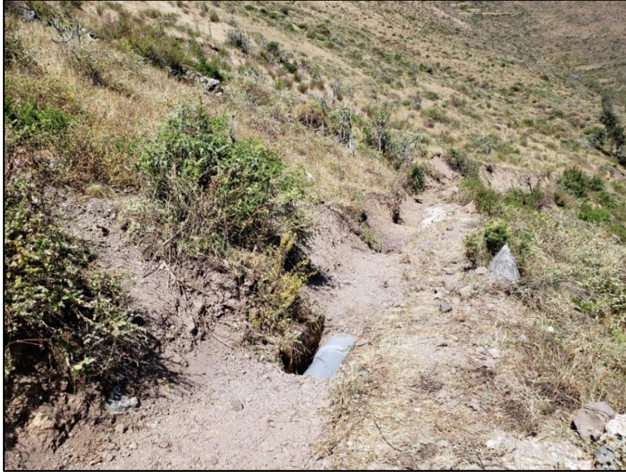
Figura 86: Relleno de protección para la tubería PVC de 400mm en el canal Utcas
