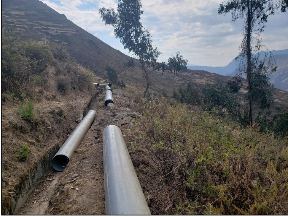
Figura 48: Vista de las tuberías PVC de 400mm por instalar en el canal Utcas
