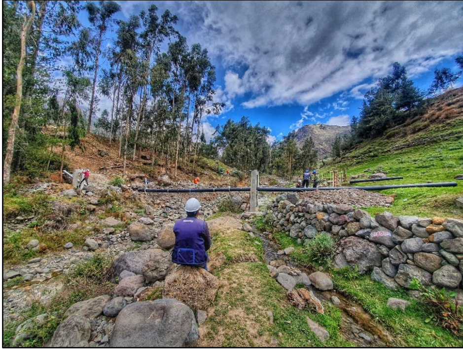
Figura 84: Pase aéreo del canal Pisacwain con tubería HDPE de 250mm
