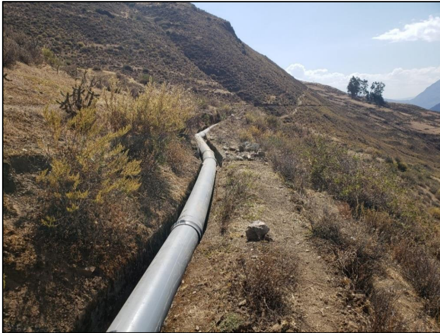
Figura 74: Vista de las tuberías PVC de 400mm instaladas en el canal Utcas
