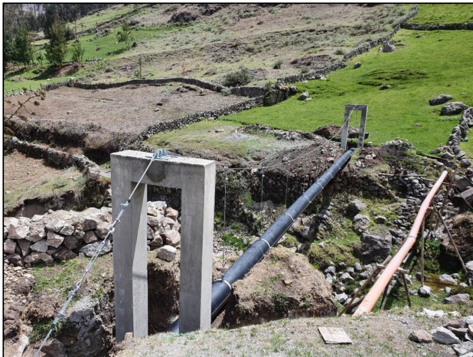
Figura 81: Pase aéreo de Utcas con tubería HDPE de 400mm
