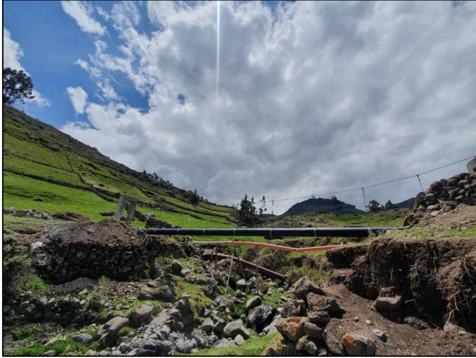
Figura 82: Pase aéreo del canal Utcas con tubería HDPE de 400mm
