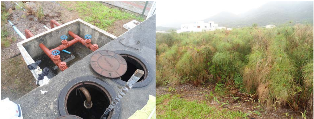
Figura 20. Humedal instalado en un condominio residencial con funcionamiento por cuadrantes alternados.
