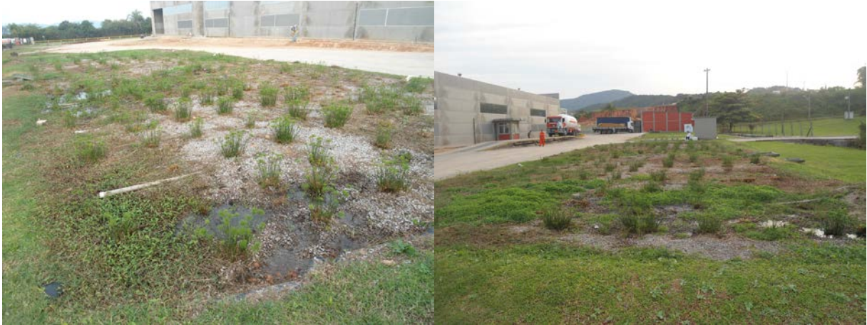
Figura 19. Identificación de problema de comatación en un humedal de flujo vertical
