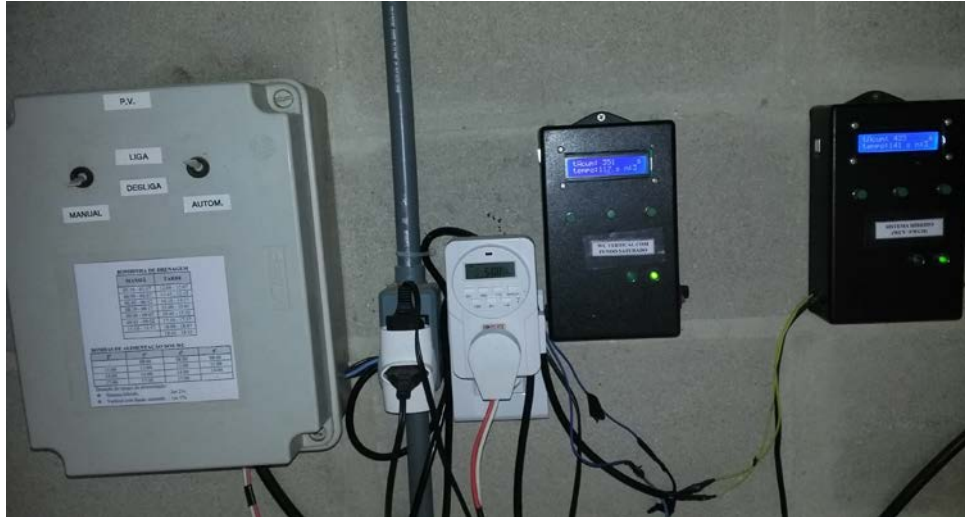
Figura 17. Panel de operación y control de bombas con timmer
