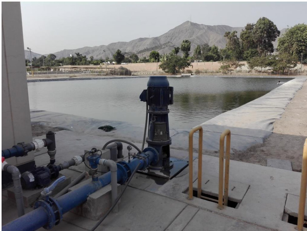
Figura 30: Unidad de bombeo y reservorio.
