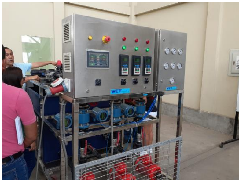
Figura 27: Motor con variador de frecuencia, Laboratorio de Recursos Hídricos, UNALM.
