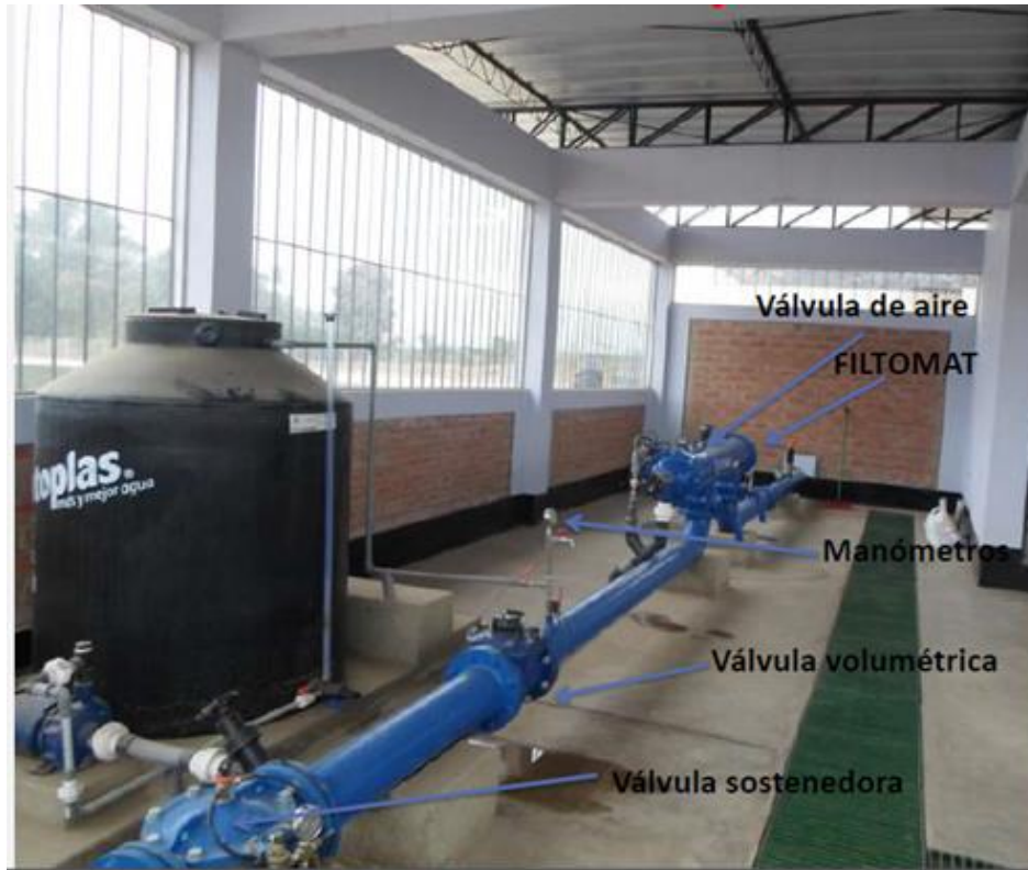
Figura 31: Cabezal de control.
