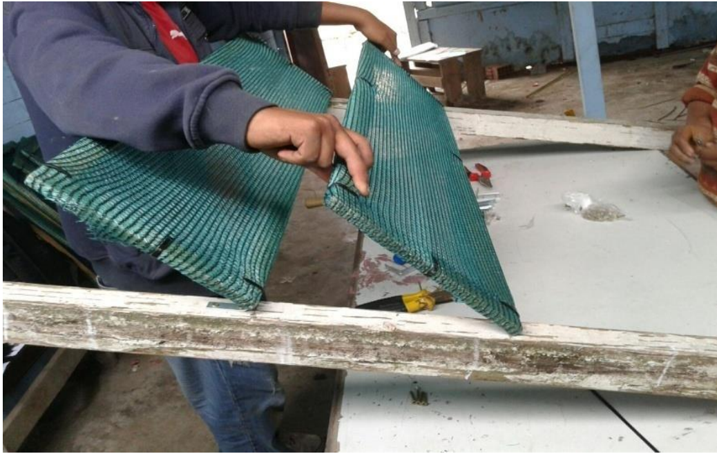
Figura 30:Proceso de elaboración de modelo árbol. Se muestran la instalación de bandejas en los postes usando ángulos de acero.
