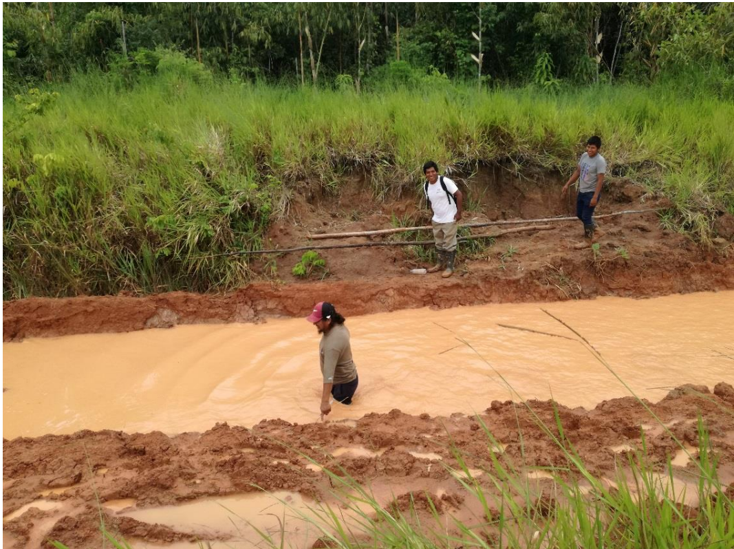
Figura 7: Sectores críticos por falta de drenaje Fuente: Real Consultores S.A.C.
