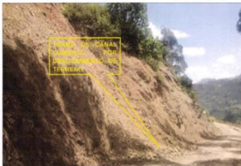
Figura 6. Km 2+740-2+780, se observa deslizamiento de terreno que ha cubierto canal existente
