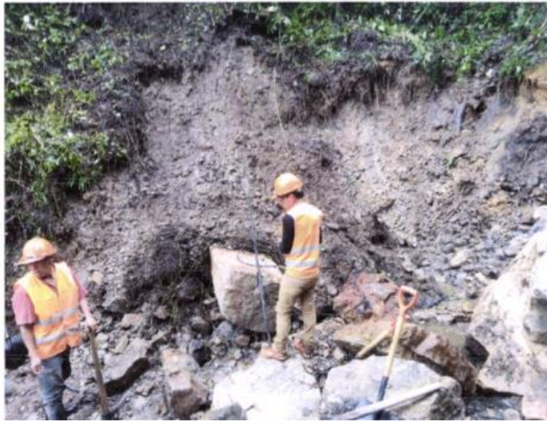
Figura 2. Vista del deslizamiento en la margen derecha donde se proyectó la captación Peña Suave
