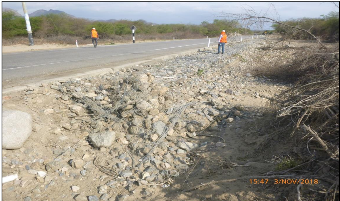
Figura 10: Muro de Gaviones colapsados
