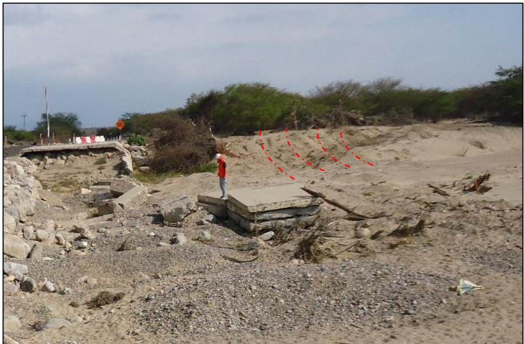
Figura 19: Socavación progresiva del margen izquierdo
