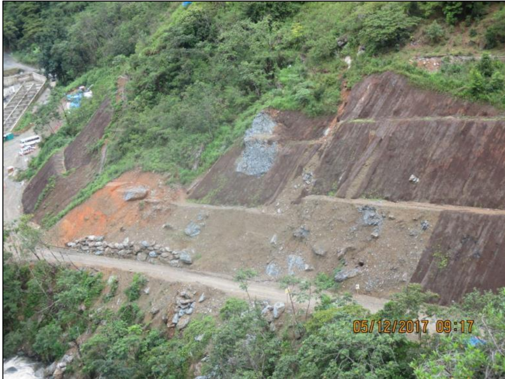
Figura 31: Tramo 0+220 – 0+300, se observa una zona de derrumbe, como medida de contención se construyó un enrocado acomodado.
