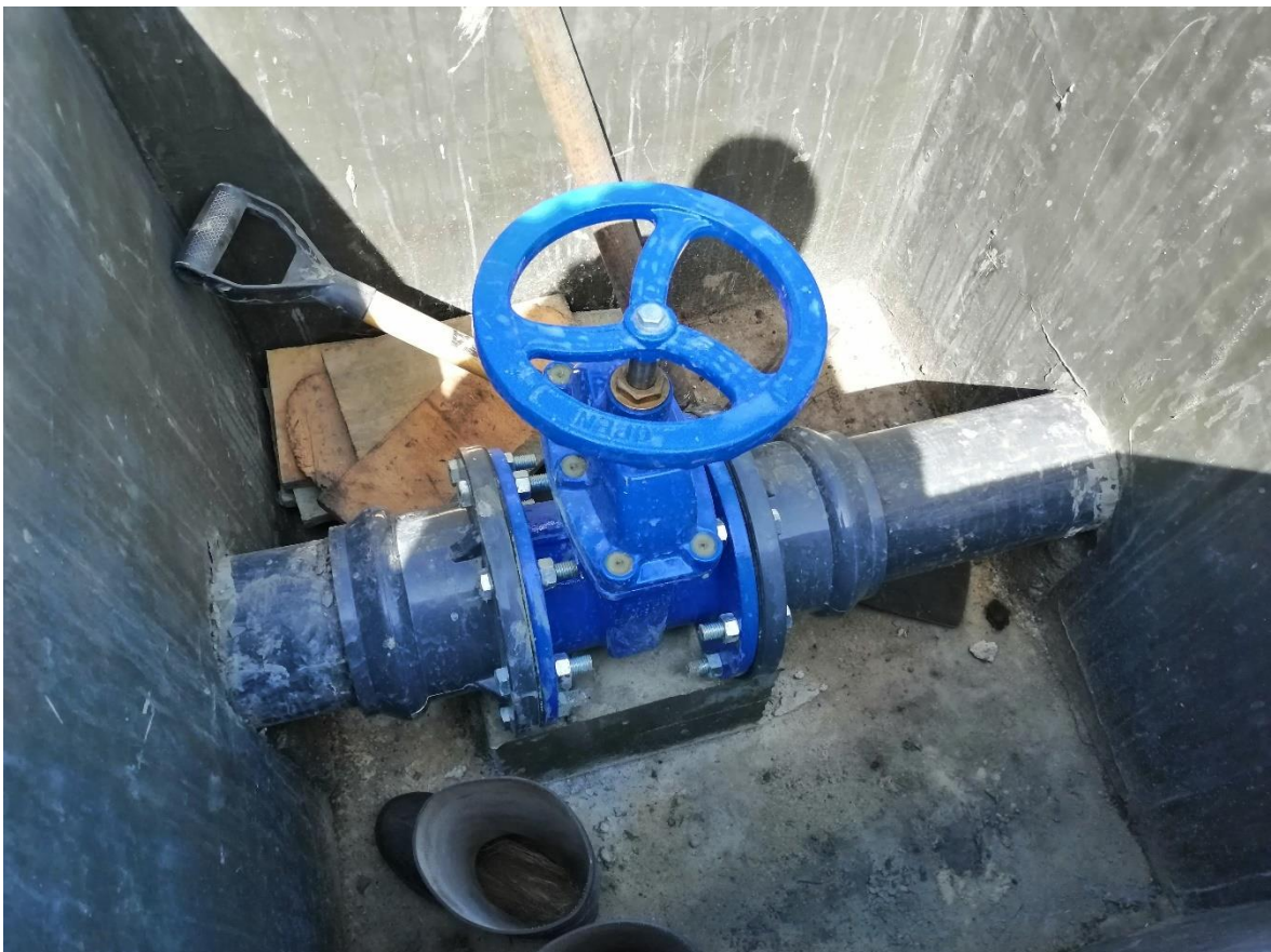
Figura 22: Válvula tipo compuerta de 160 mm instalada en la descarga
