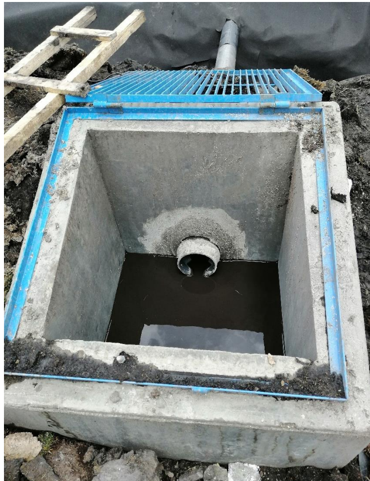
Figura 21: Rejilla instalada en la estructura de toma
