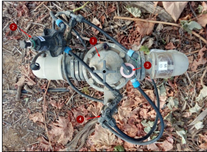
Anexo 26: Válvulas hidráulicas Dorot (1), piloto regulador de presión Dorot (2), válvula Sagit de tres vías (3), relay de mando hidráulico
