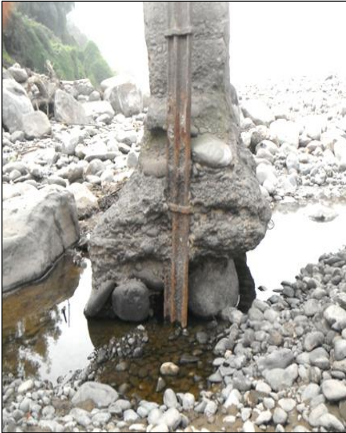
Figura 31: Pilar parcialmente socavada
