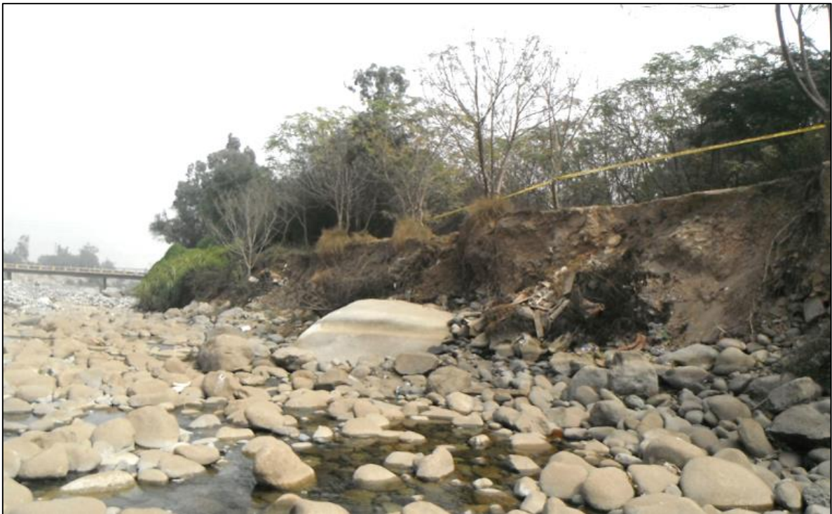
Figura 34: Desprendimiento en la margen norte del río
