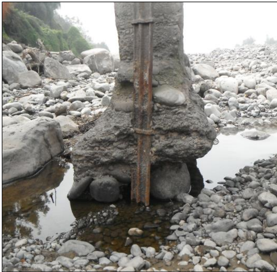
Figura 32: Vista general y de los Pilares afectados
