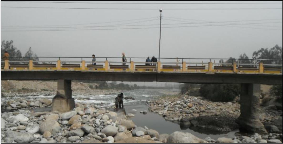
Figura 33: Vista de la antigua ubicación del pilar destruido
