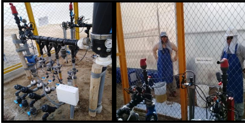
Figura 15: Tecnología de inyección en válvula de riego
