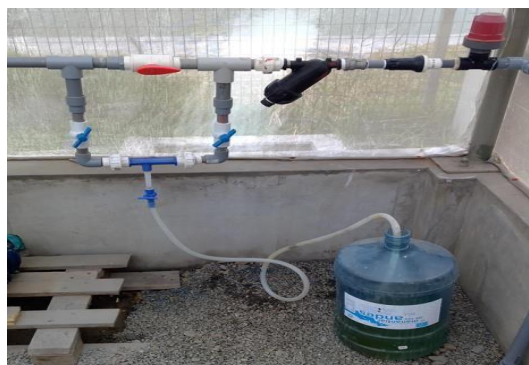
Instalación del Venturi para el Fertirriego
