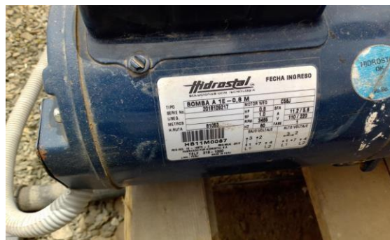
Bomba de agua: Hidrostat 5HP
