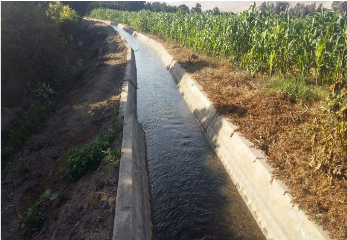
Figura 28: tramo crítico de muro izquierdo de la canal existente progresiva Km. 0+200
