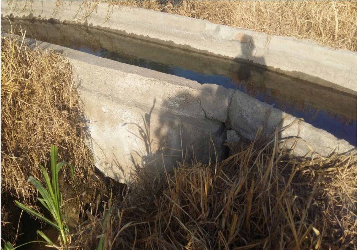
Figura 29: tramo crítico de muro izquierdo de la canal existente progresiva Km. 0+220
