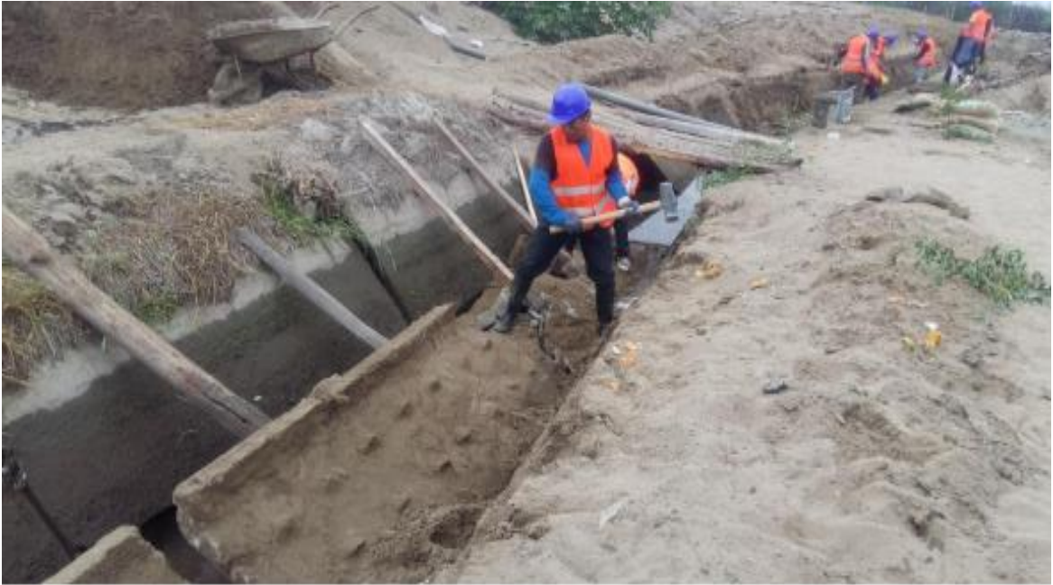
Figura 30: Demolición de estructura de tramo crítico de muro izquierdo de la canal existente
