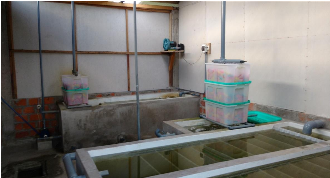
Vista de los sedimentadores de placas, parte del sistema de recirculación de agua, retención de sólidos.
