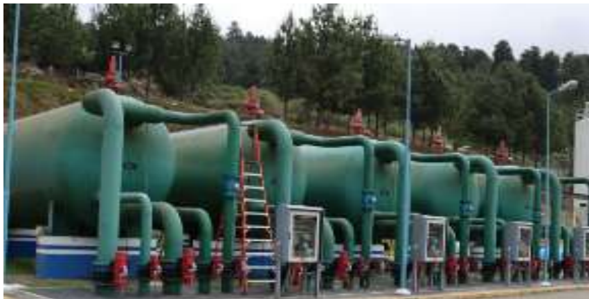
Figura 18. Planta de agua potable Carigán.
