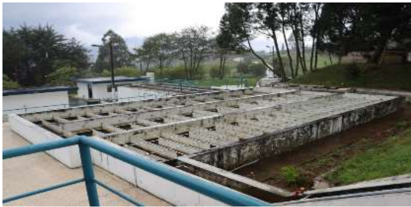
Figura 17. Planta de agua potable Chontacruz.
