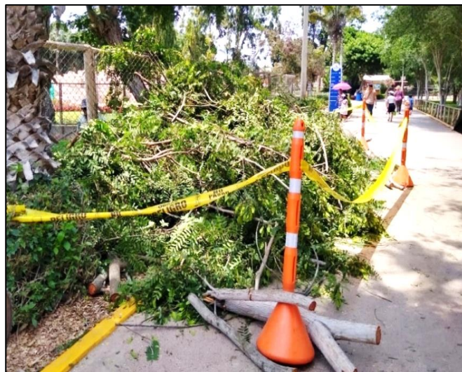
Figura 30. Uso de los implementos de seguridad para asegurar el área de trabajo
