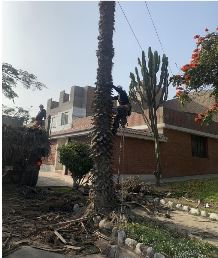
Figura 10. Técnicas inadecuadas de acceso vertical. Fuente: Fotografía propia, 2020
