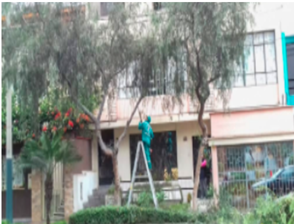
Figura 9. Falta de implementos adecuados para podas en altura. Fuente: Fotografía propia, 2020.
