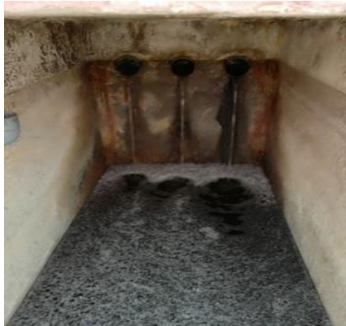
Figura 18. Salida de agua de la cámara 3 hacia la cámara 4
