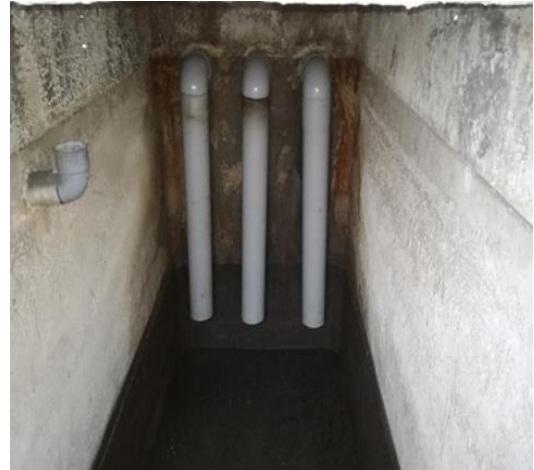
Figura 19. Tubería de salida de la cámara 3 hacia la cámara 4
