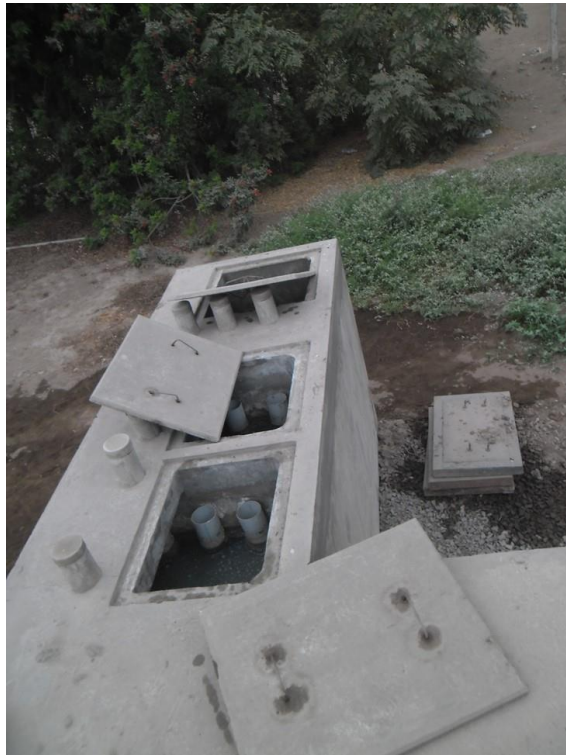
Figura 52. Cámaras del tanque baffled
