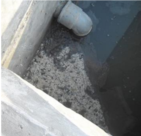
Figura 16. Tubería de entrada al tanque baffled
