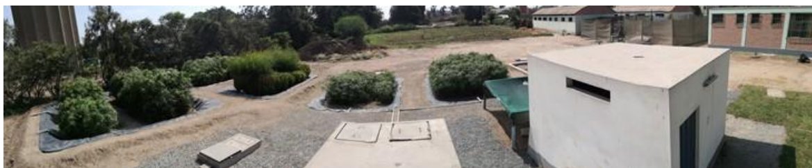
Figura 39. Planta piloto de tratamiento de aguas residuales domésticas
