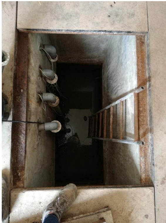
Figura 44. Pozo Cisterna de almacenamiento de aguas residuales domésticas
