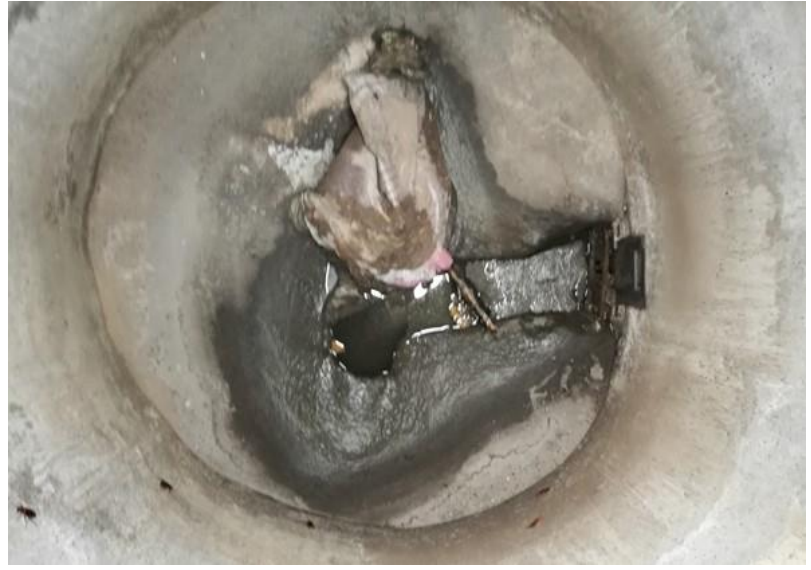
Figura 41. Interior del buzón de derivación
