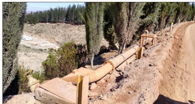
Figura 12: Tubería de distribución de fierro de 6”
