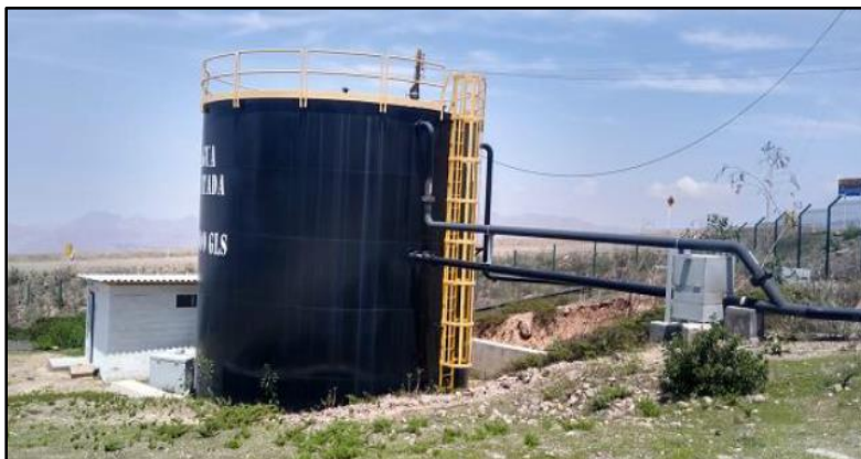
Figura 22: Tanque de almacenamiento – Villa Cuajone
