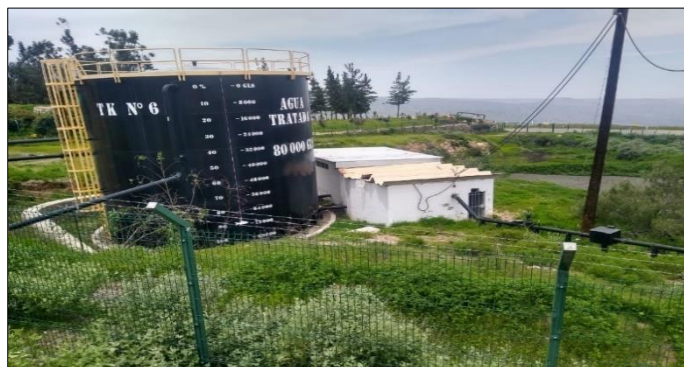
Figura 13: Tanque de almacenamiento de 80,000 galones – Villa Cuajone
