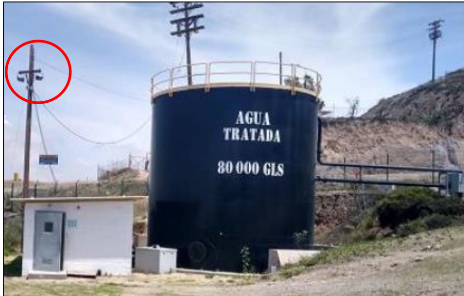
Figura 6: Caseta con suministro de energía eléctrica en Villa Cuajone
