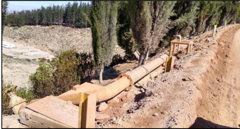
Figura 21: Tubería de distribución de 6” – Villa Botiflaca
