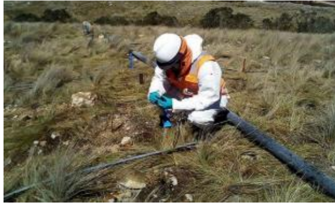
Figura 2: Sistema de riego por micro aspersión instalado en la minera Barrick Lagunas Norte
