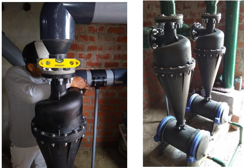
Figura 18: Hidrociclones instalados en la caseta de agua de pozo
