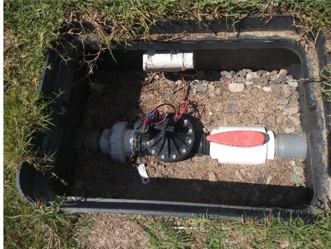
Figura 32: Arco de riego instalado en campo
