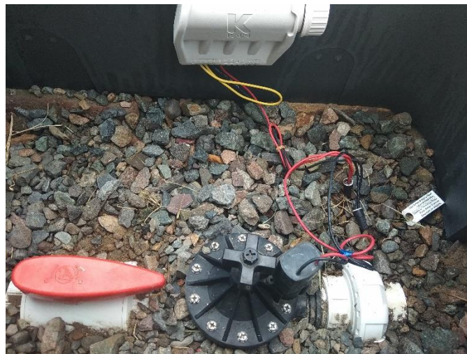
Figura 39: Programador BL-KR de una estación instalado en campo
