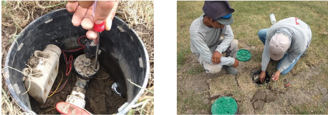
Figura 48: Capacitación de limpieza, mantenimiento y operación de las electroválvulas a personal técnico del condominio
