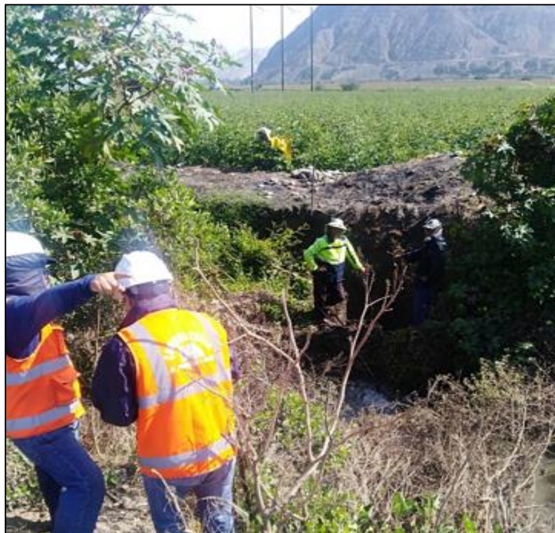
Figura 23: Deslizamiento del talud en el tramo del canal sin revestir
