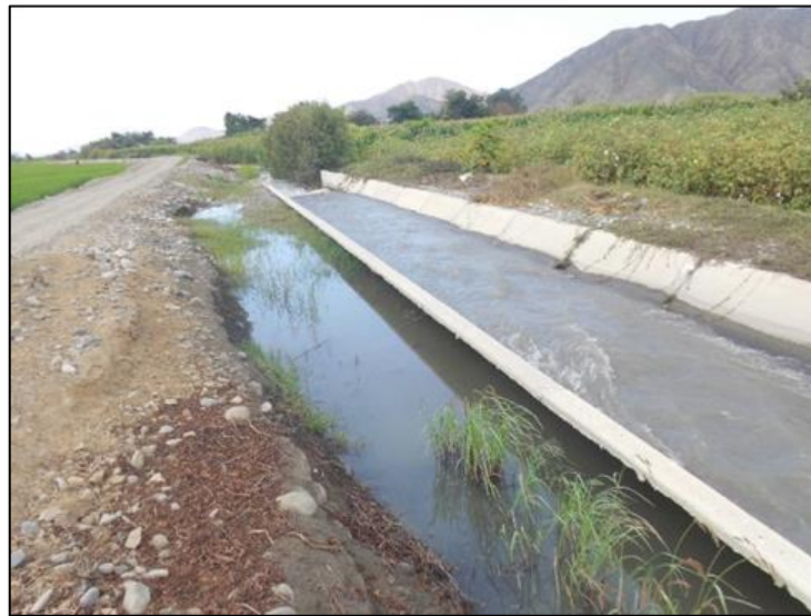
Figura 11: Paño de canal socavado
