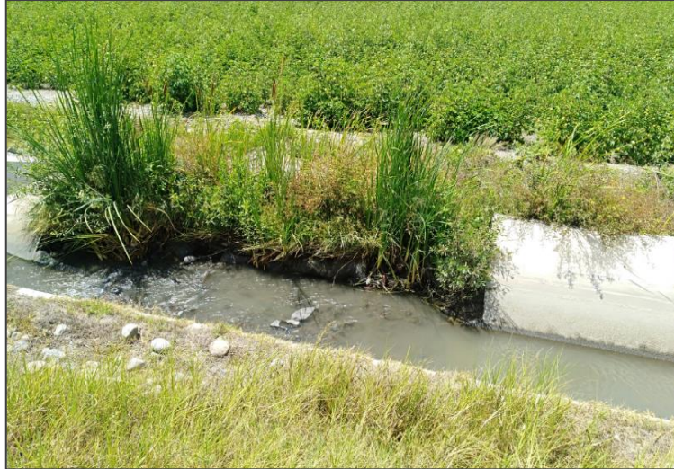
Figura 9: Tramo de canal destruido
