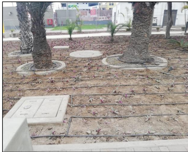
Figura 22: Riego por goteo obras exteriores zona A
