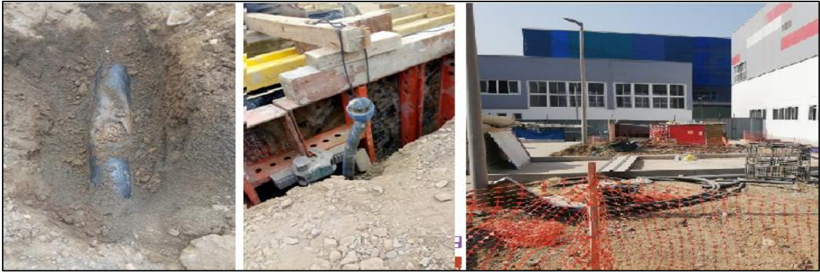
Figura 94: Daños generados a trabajos realizados y zonas no liberadas
