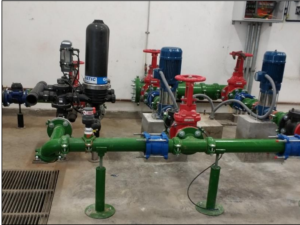
Figura 12: Cabezal de riego Obras Exteriores Zona A
