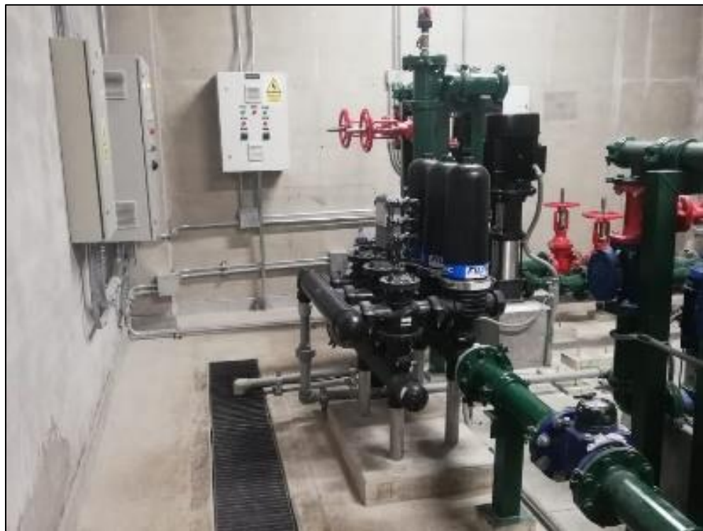
Figura 29: Manifold de filtrado de estadios vista de perfil
