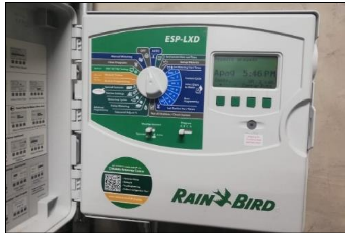
Figura 26: Tablero controlador de riego Rind Bird ESP LXD en obras exteriores
