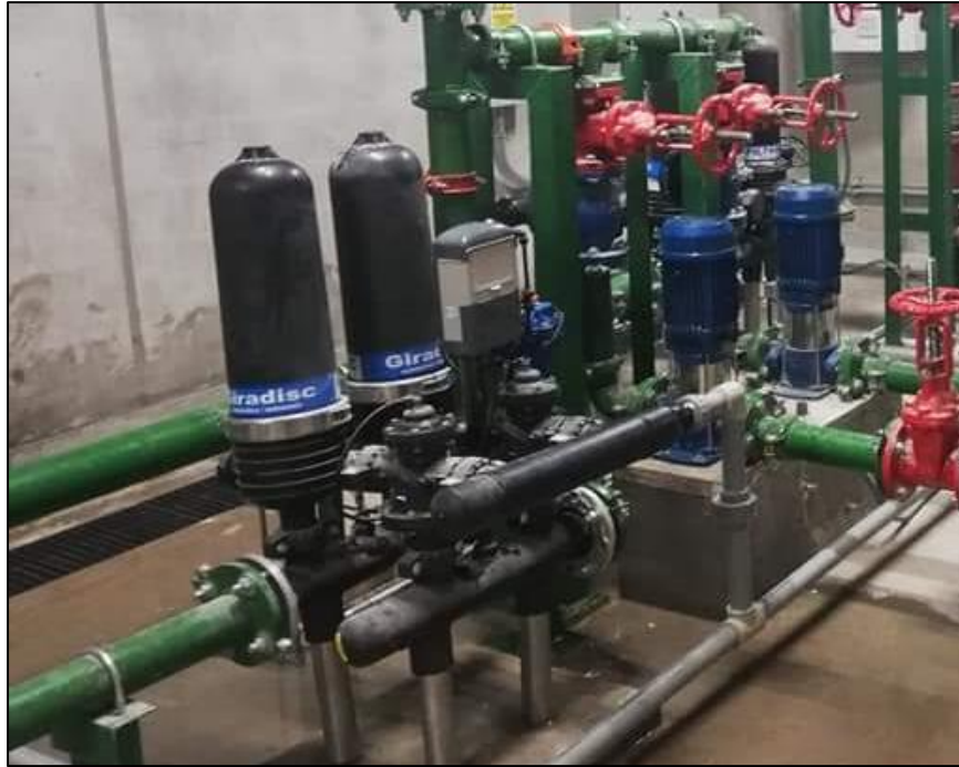
Figura 13: Cabezal de riego obras exteriores zona B
