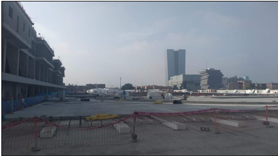
Figura 50: Vaciado de concreto en loza de Estadio de Calentamiento sin considerar pase para la red de Riego Tecnificado
