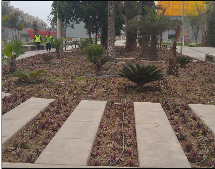
Figura 21: Riego por goteo obras exteriores zona A
