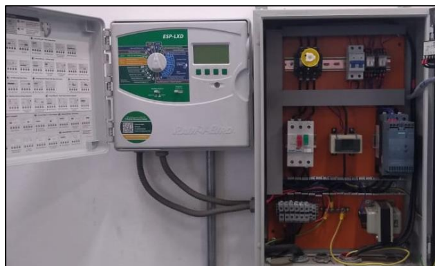
Figura 25: Talero controlador de riego Rind Bird ESP LXD y tablero de electrobombas
