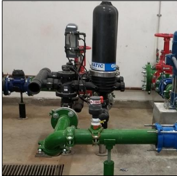
Figura 14: Manifold de filtrado obras exteriores zona A
