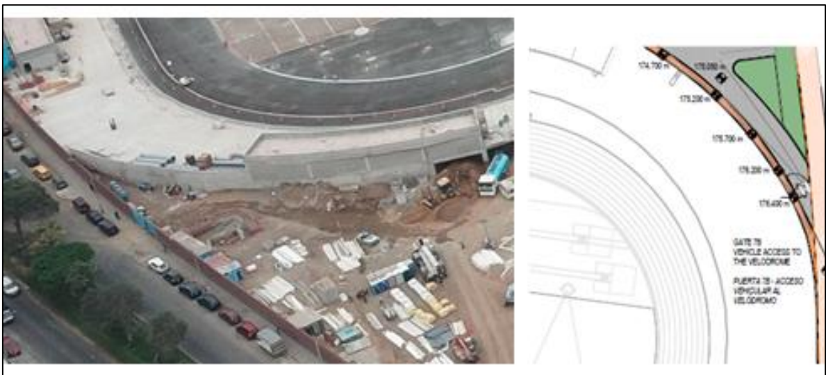
Figura 68: Comparación de las herramientas BIM y plano para ejecución de obra en sector 2 fase 2
