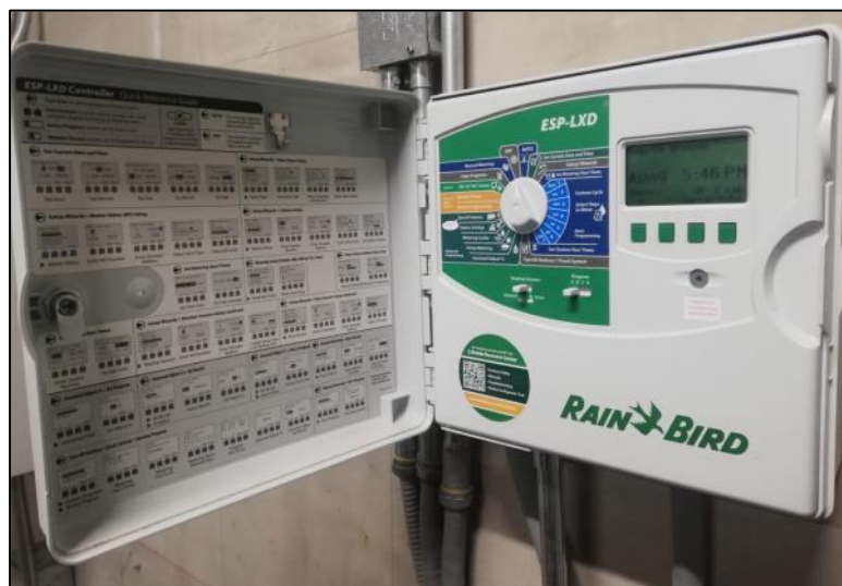
Figura 38: Tablero controlador de riego Rain Bird ESP LXD en estadios
