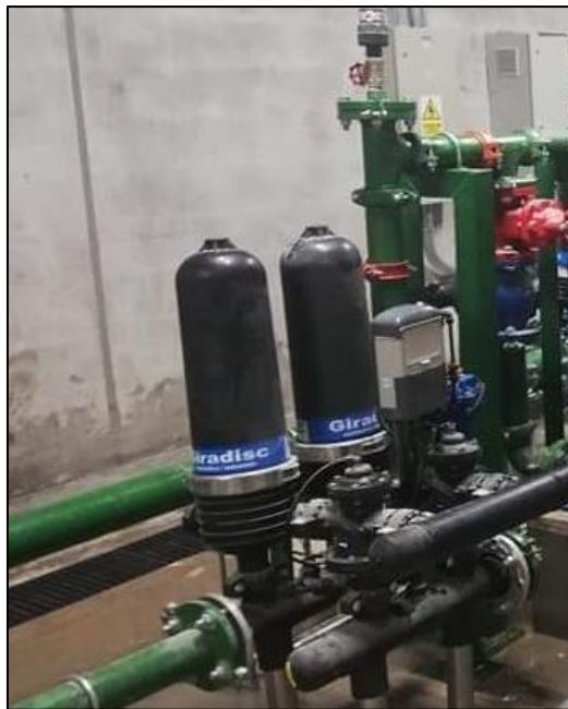
Figura 15: Manifold de filtrado obras exteriores zona B
