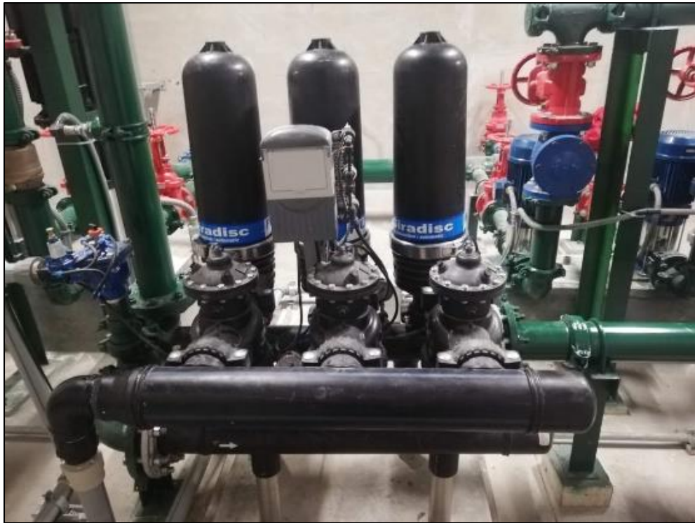
Figura 28: Manifold de filtrado de estadios vista frontal
