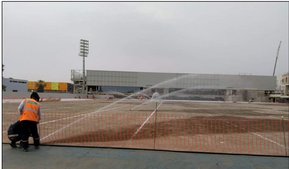
Figura 36: Regulación de emisores de riego en estadio de calentamiento
