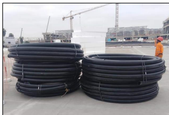
Figura 31: Tuberías HDPE 90 mm para instalación en estadio de calentamiento
