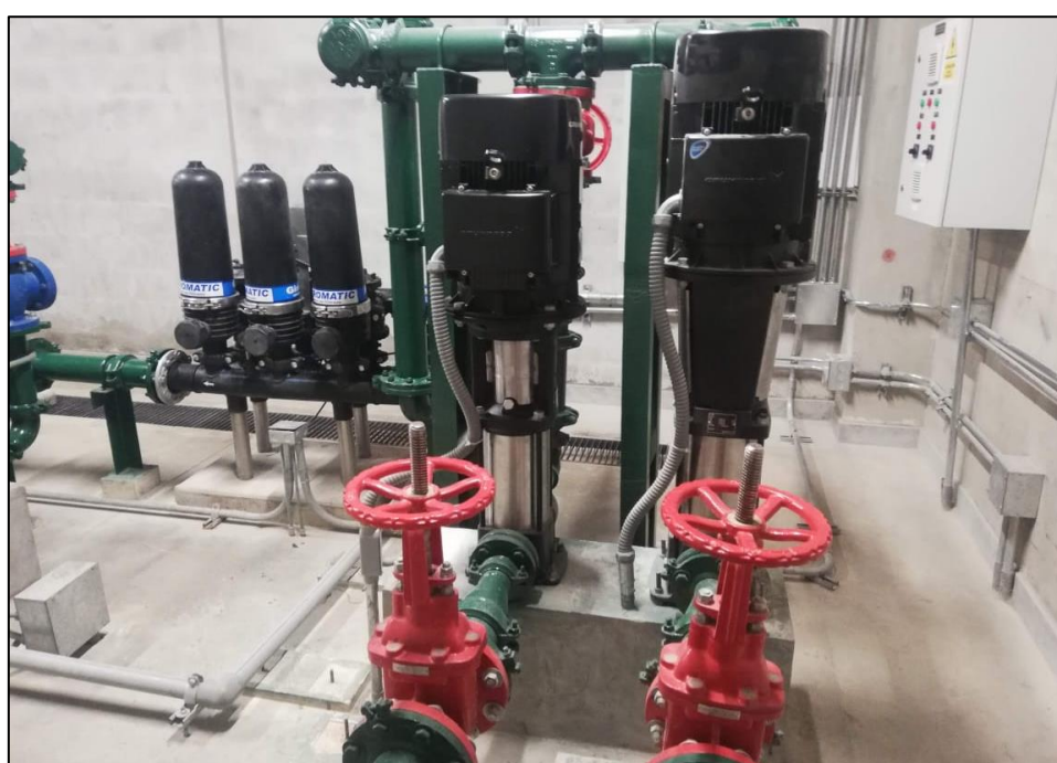
Figura 27: Cabezal de riego de estadios
