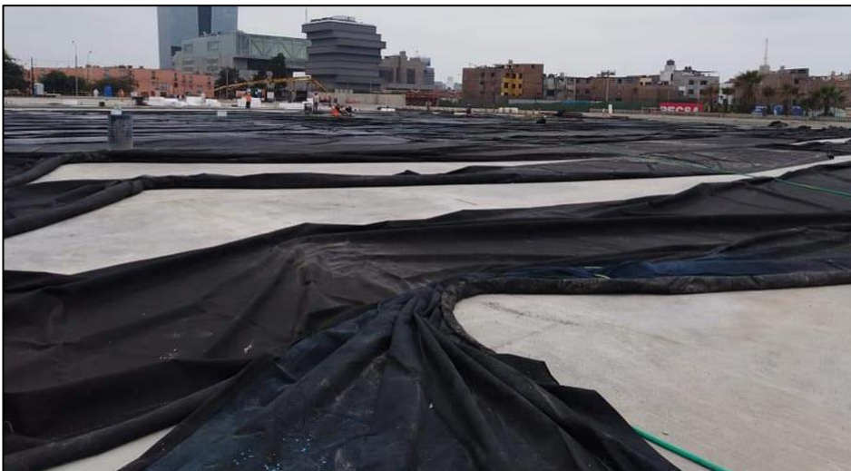
Figura 51: Loza de concreto vaciada sin considerar niveles para instalación de tuberías de riego tecnificado
