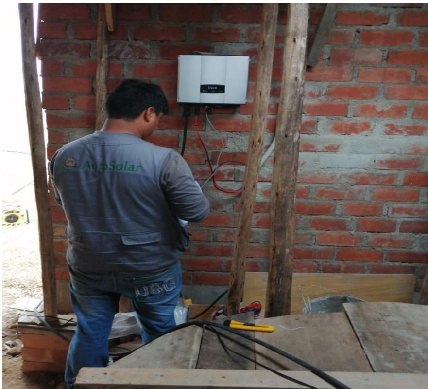
Figura 29: Conexión de cables eléctricos, inversor, paneles solares y electrobomba.
