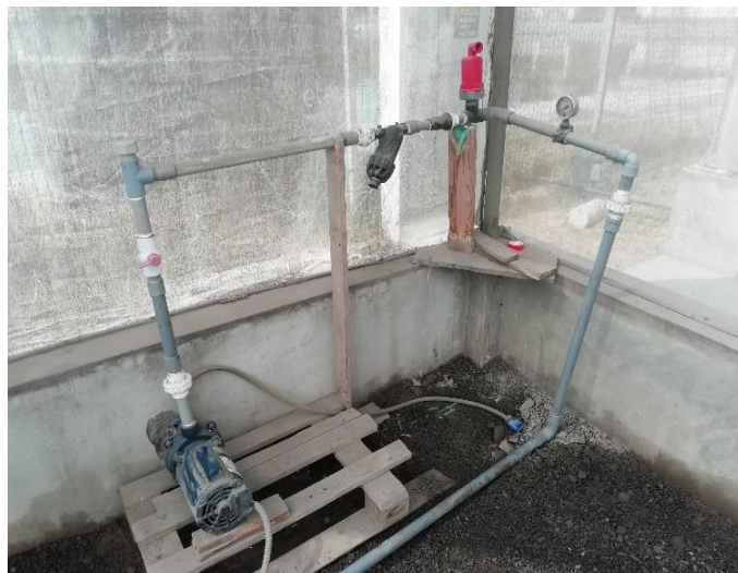
Figura 12: Sistema de riego instalado
