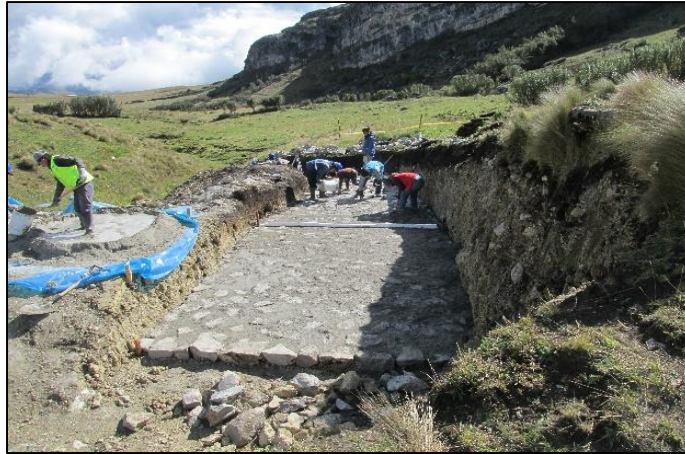
Figura 51: Emboquillado en el fondo del aliviadero 01
