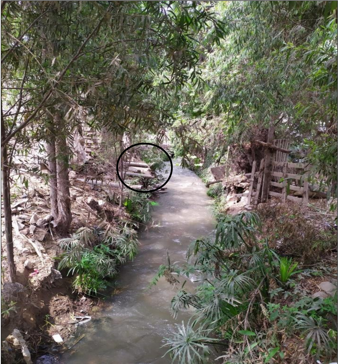
Figura 18: Tuberías de aguas servidas
