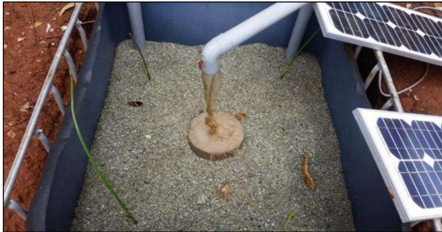
Figura 36: Ingreso de lixiviado en C.F. 1-3
