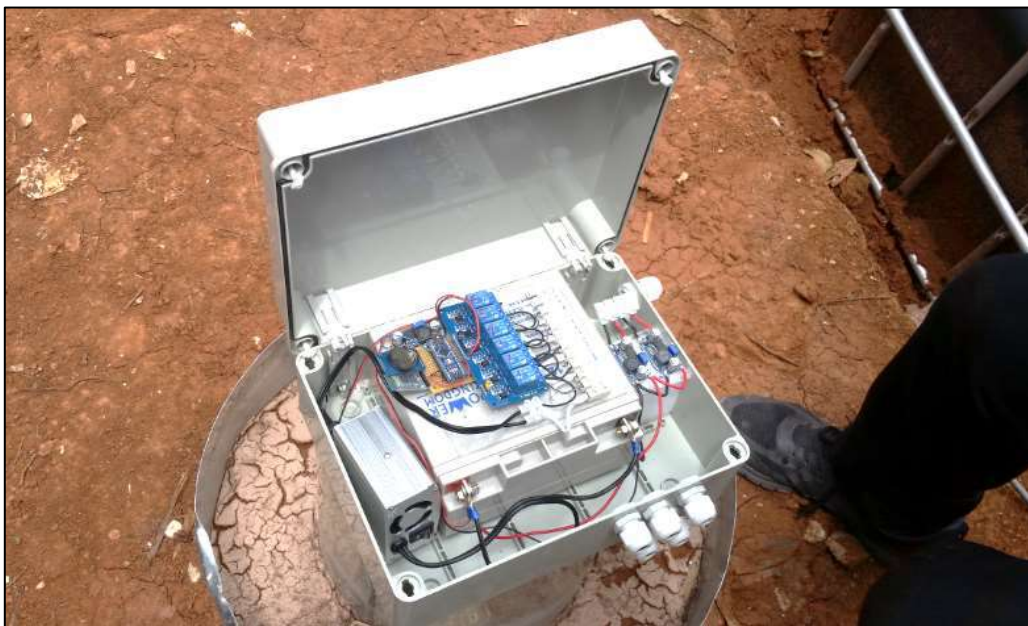
Anexo 1.4. Controlador de carga, controlador de bombas, batería e inversor del sistema fotovoltaico del piloto
