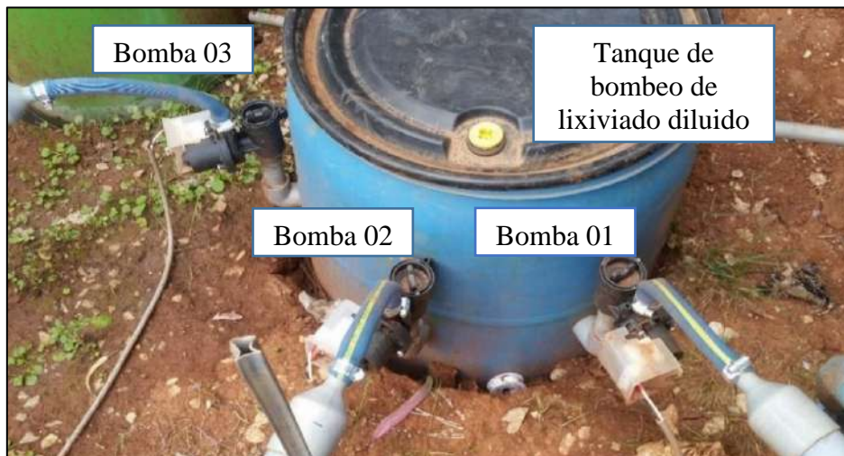
Figura 30: Tanque de bombeo de lixiviado diluido
