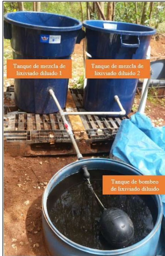
Anexo 1.3. Tanques de mezcla y tanque de bombeo de lixiviado diluido
