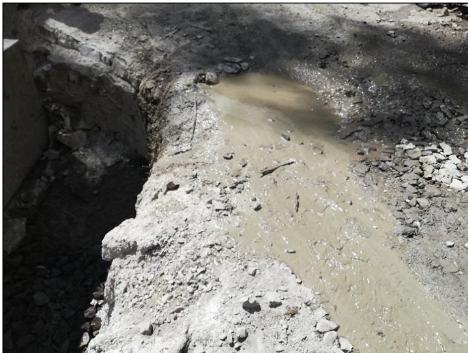
Figura 16: Contaminación del suelo por hormigón
