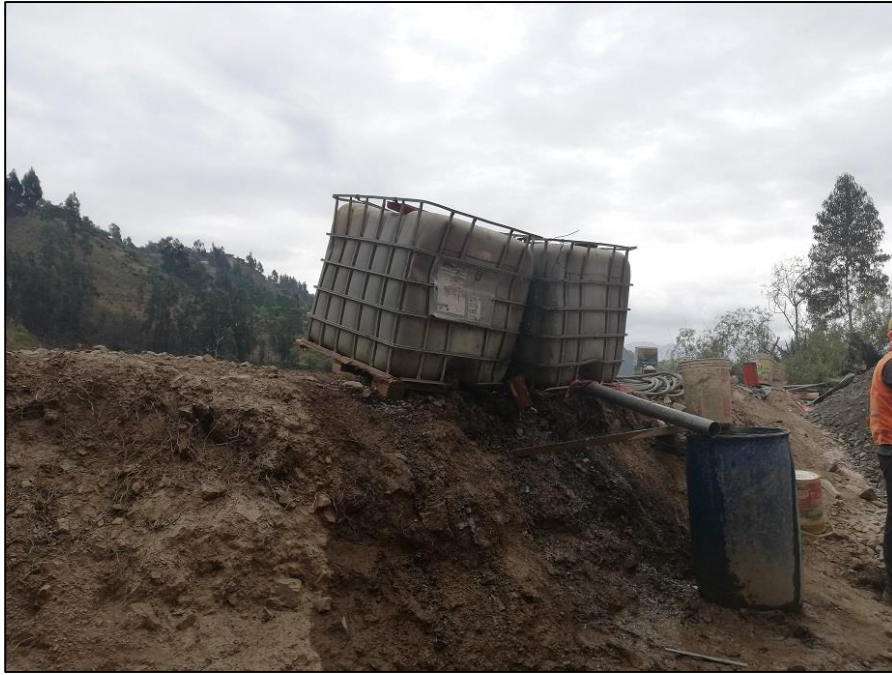
Figura 23: Contaminación del suelo por hidrocarburos
