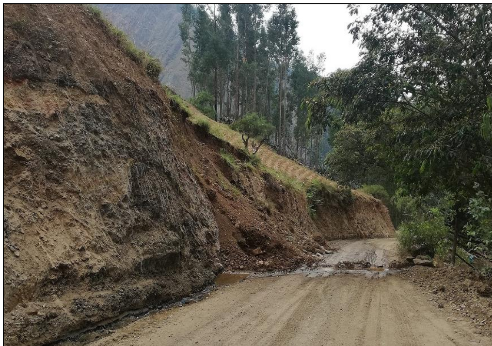
Figura 26: Deslizamiento de Talud
