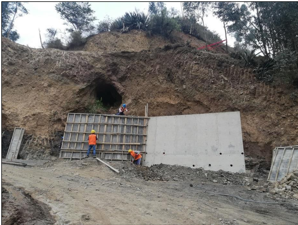
Figura 20: Zona identificada como posible derrumbe
