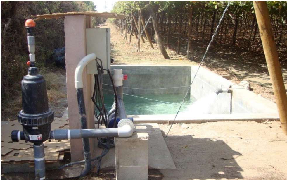
Figura 6: Reservorio con sistema de bombeo
