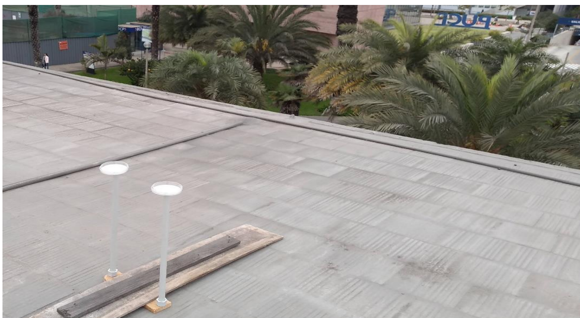
Anexo 9.- Placas receptoras instaladas en la azotea del Pabellón de Física.
