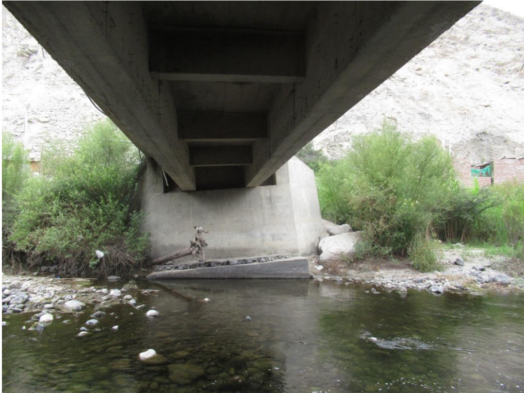
Figura 98: Vista del estribo izquierdo con problemas de socavación
