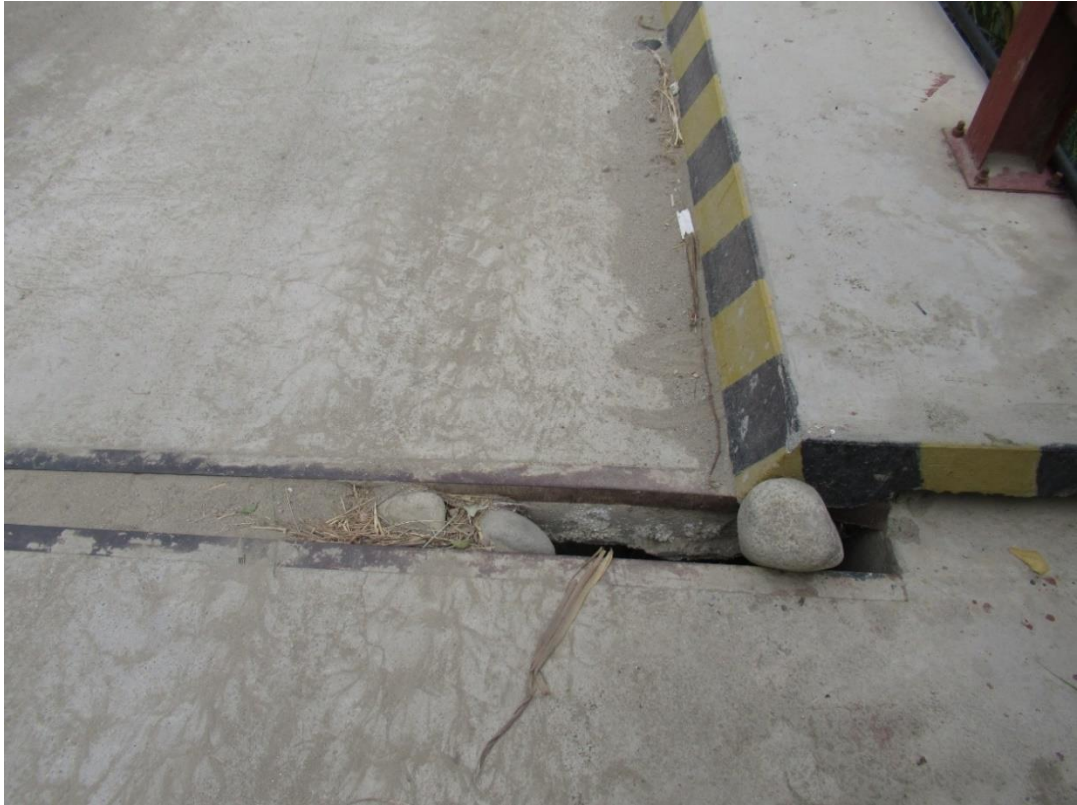
Figura 100: Problemas en el emplazamiento del tablero sobre los estribos y los sumideros de drenaje se encuentran completamente obstruidos
