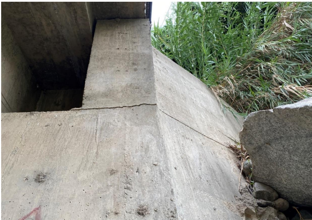
Figura 99: Fisuras en la estructura del puente
