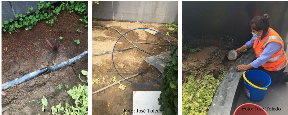
Figura 9: Aniego en techo verde por deterioro del sistema de riego.
