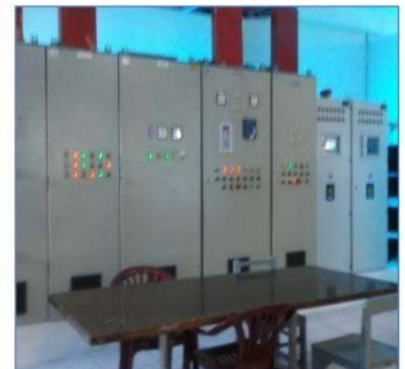
Sala de Tableros de Control y Mando
