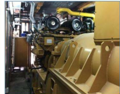
Vista del grupo de generación
