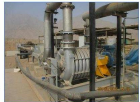
Planta de tratamiento de biogás
