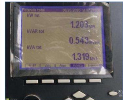
Panel de control del Grupo N° 1
