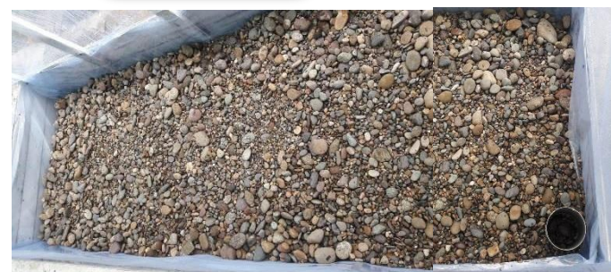
Piedras ya desinfectadas, listas e instaladas en las cámaras de subirrigación
