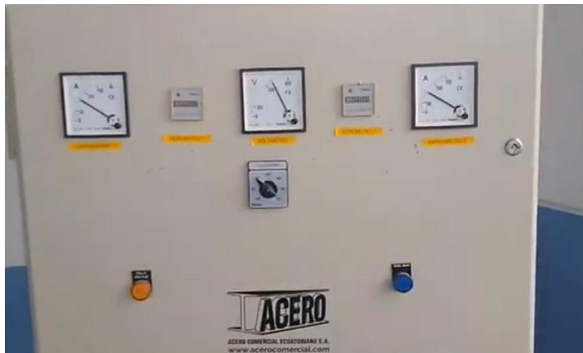
Figura 64: Lectura de los medidores de tensión e intensidad de corriente de las dos bombas de riego una vez encendido el sistema, se puede observar que el amperaje entre bombas es casi el mismo
