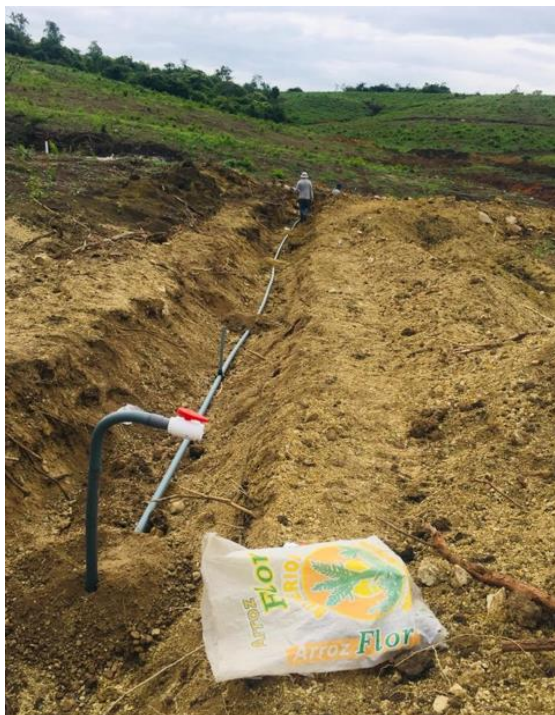
Figura 29: Instalación de collarines de boca de 1" de diámetro en la submatriz, conectados a un elevador de 50cm de alto x 32mm de diámetro; a los que se adhieren tees o codos para distribuir el agua a los laterales de riego
