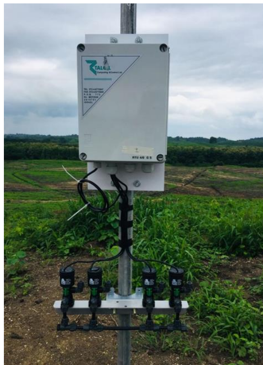
Figura 60: Antena RTU repetidora con regleta de solenoides DC latch 12V
