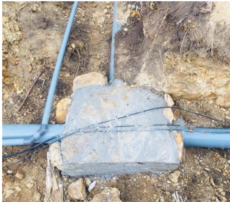
Figura 44: Anclaje de concreto para tee de 160mm ejecutado por el cliente, la cual se observó por ser desuniforme y no tener la forma adecuada para proteger al accesorio
