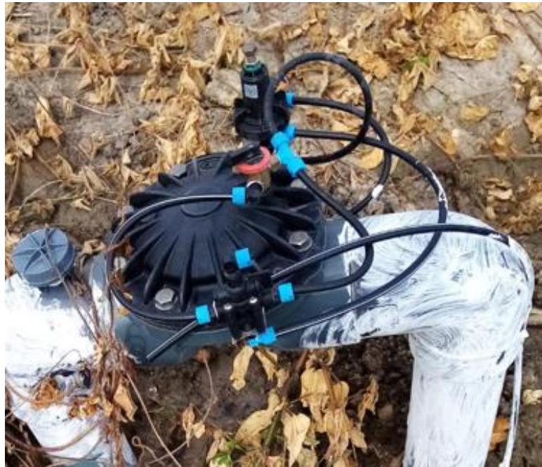
Figura 72: Arco de riego instalado en La Estación
