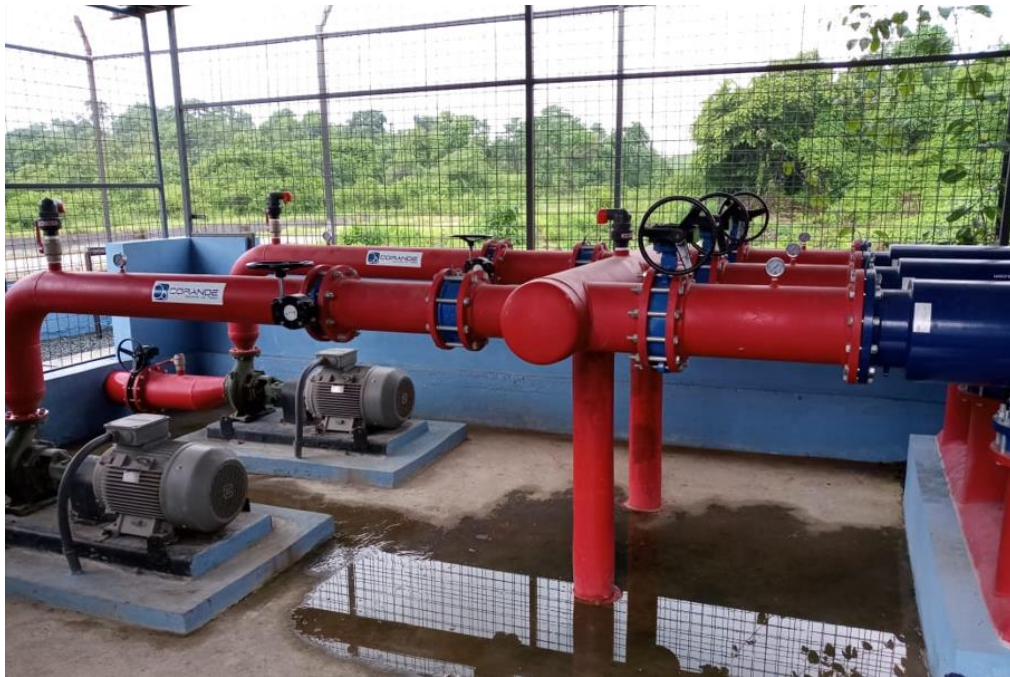
Figura 49: Bombas centrífugas NCB 100-200 75HP instaladas
