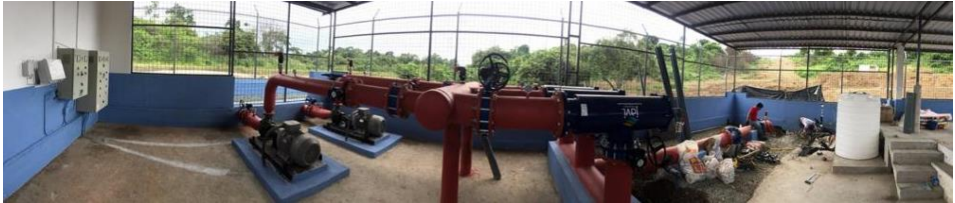
Figura 51: Cabezal de riego de la Hacienda La Estación donde se pueden observar los instrumentos antes descritos
