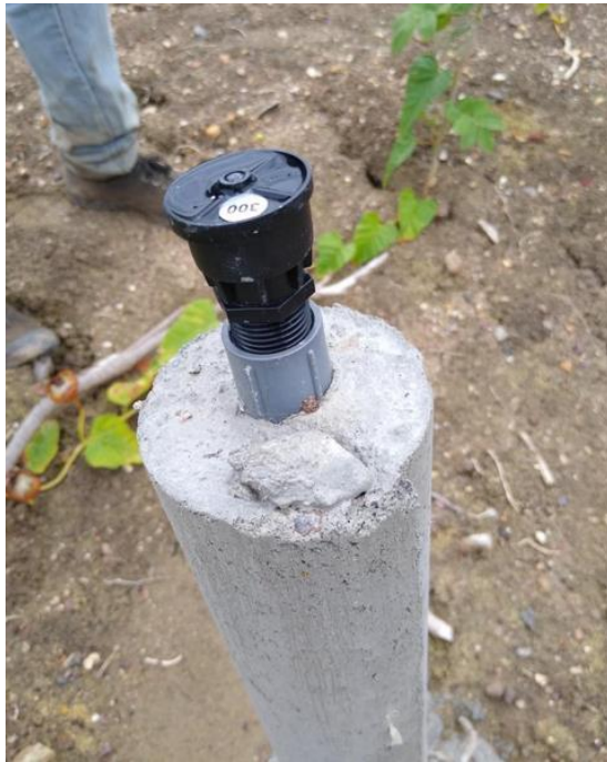
Figura 69: Muñeco con aspersor tavlit 920 instalado
