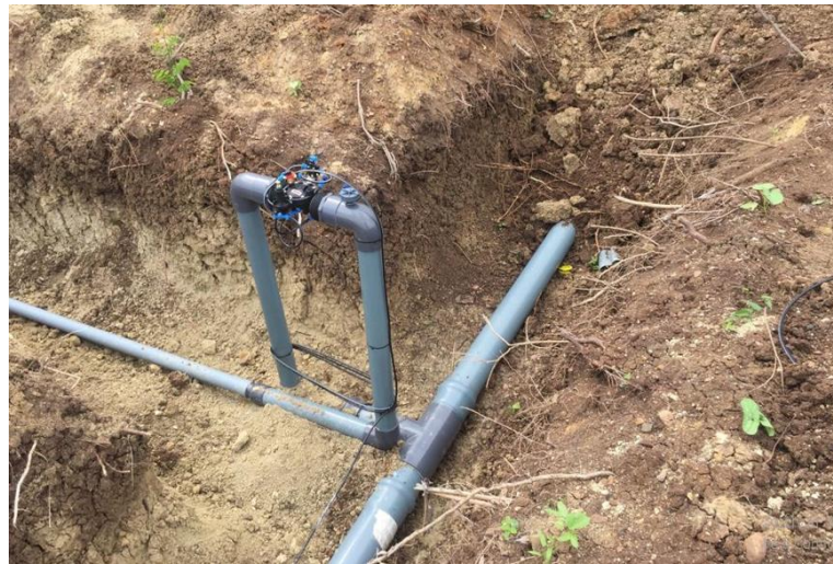
Figura 32: Instalación de arco de riego y tubería submatriz
