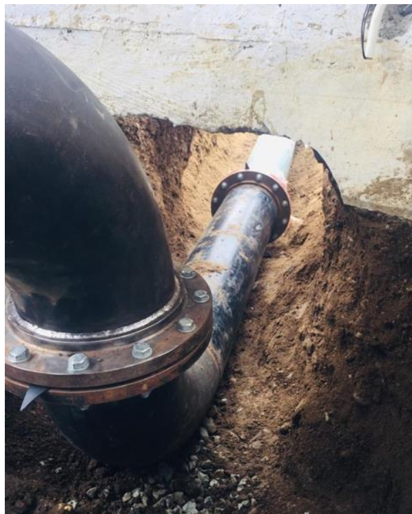
Figura 37: Instalación de “S” de fierro 12” conectada a través de un terminal brida-campana con la conducción de PVC de 315mm
