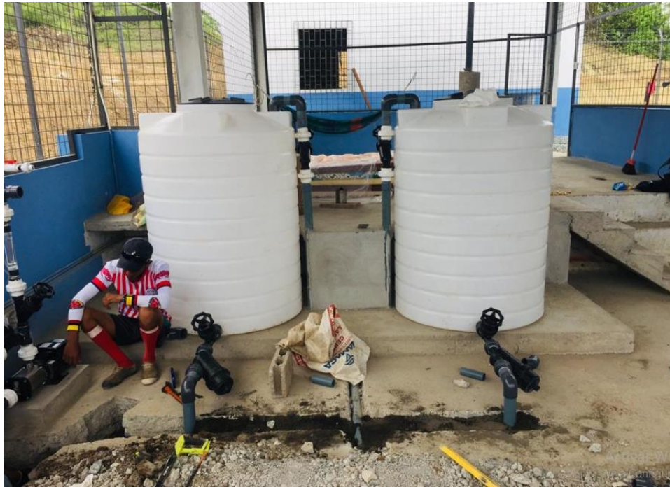
Figura 53: Instalación del equipo de fertilización
