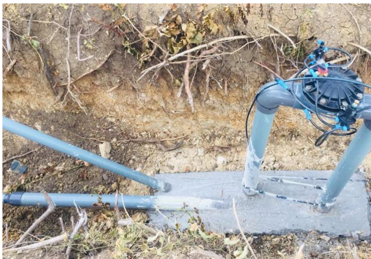
Figura 45: Anclaje de válvula hidráulica y purga de matriz
