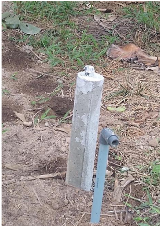
Figura 46: Muñeco con cinta scotch en la boquilla, junto a una purga de tubería lateral
