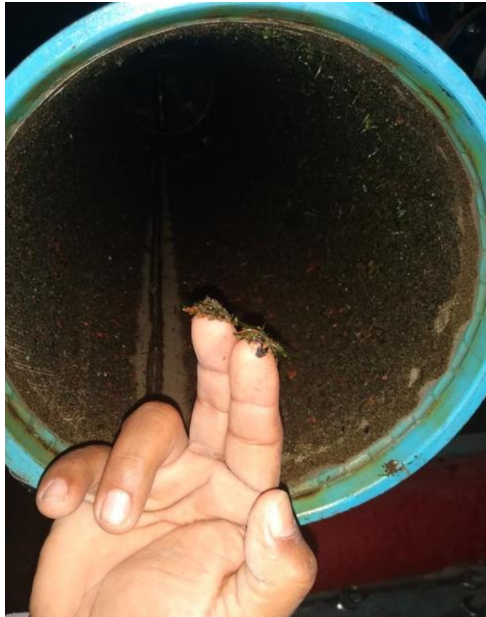
Figura 65: Suciedad que se acumula dentro del filtro en apenas 20 minutos, tiempo en el que entre la entrada y salida de filtros se puede observar una pérdida de carga de 2 bares
