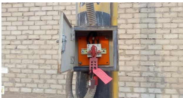
Figura 12. Bloqueo de energía con candados dieléctricos. Antes de empezar las podas en zonas energizadas se debe realizar el bloqueo respectivo.
