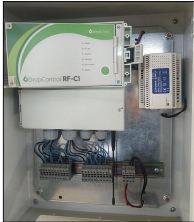
Figura 41: Nodo RF-C1 instalado en la caseta de riego
