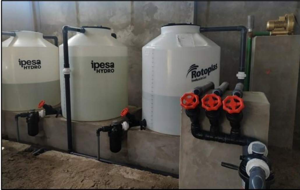
Figura 38: Tanques de almacenamiento de 1100 l y bomba blower de 3.5 HP
