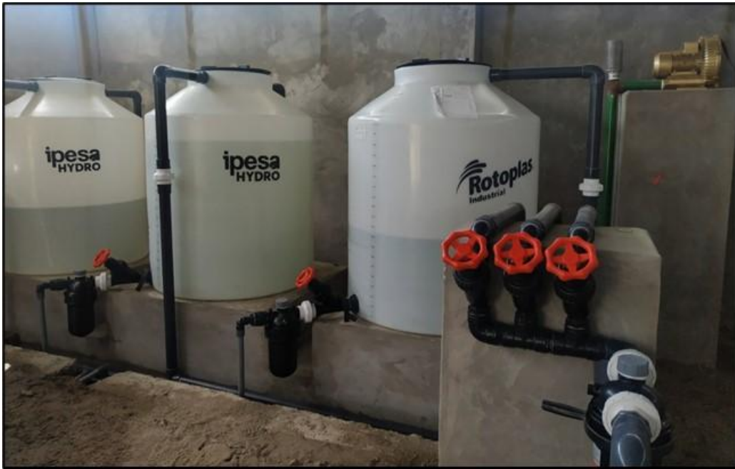
Figura 39: Tanques de almacenamiento de 1100 l y bomba blower de 3.5 HP
