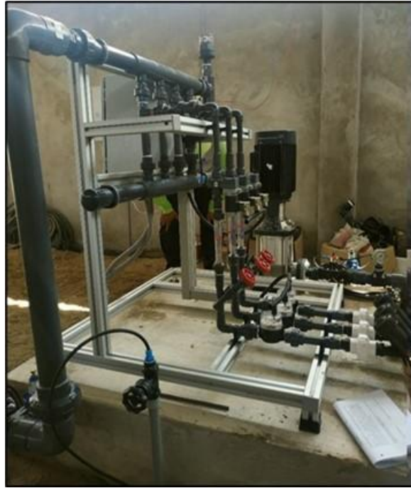
Figura 36: Mesa de fertilización con tres canales de inyección
