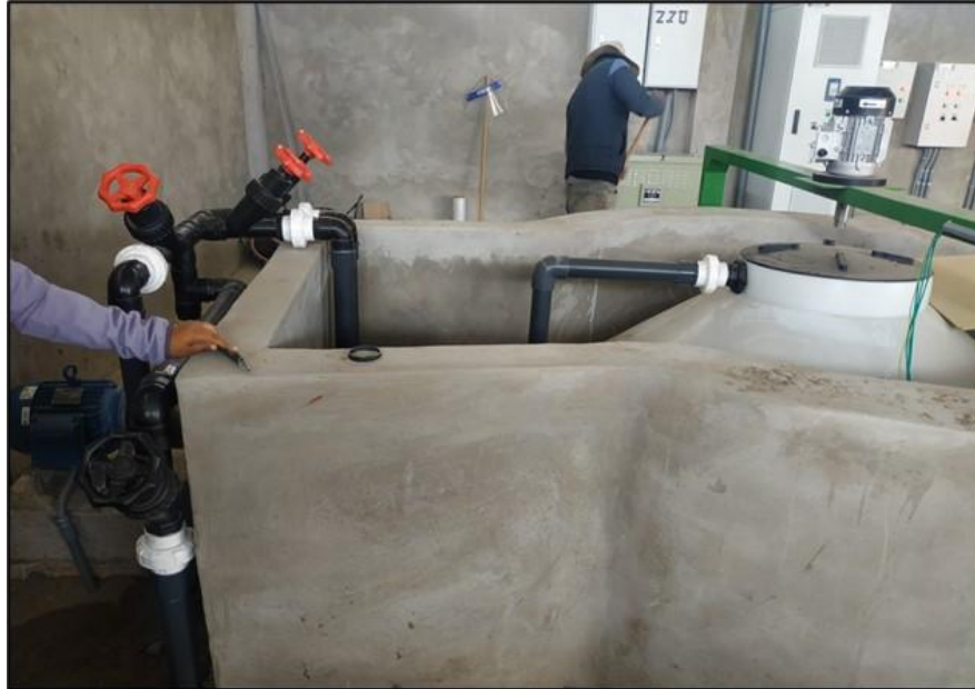
Figura 37: Tanque de dilución de 2500 l y bomba Q-pump de 7.5 HP
