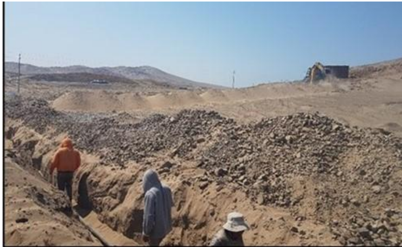
Figura 18: Presencia de piedras en la excavación de zanjas
