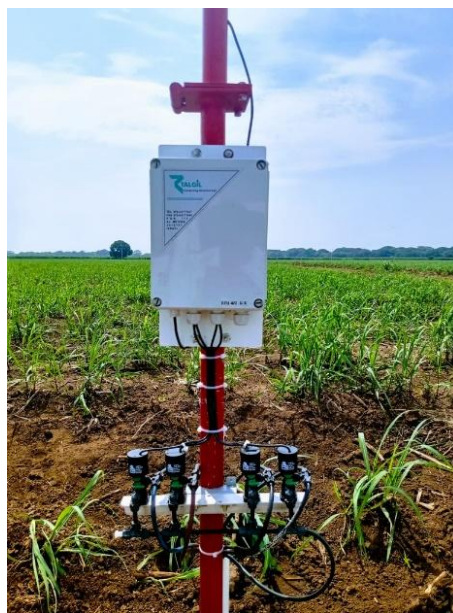
Figura 4: Unidad en campo – RTU y barra de solenoides
