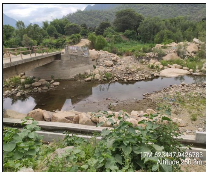
Figura 39: Sedimentación de cauce de río en puente actual
