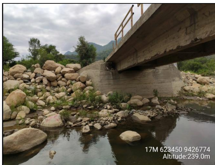
Figura 38: Erosión de lado izquierdo de Puente actual Chalaco
