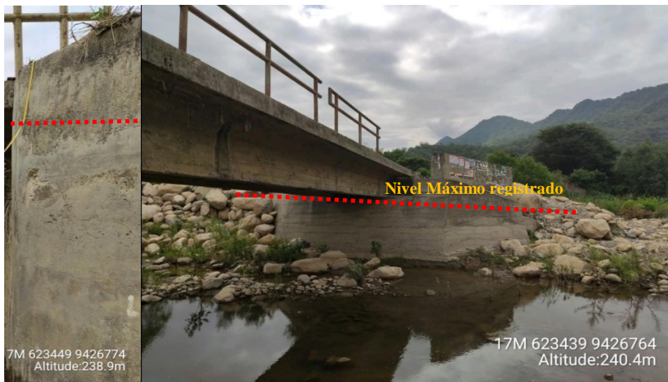
Figura 33: Huella máxima vista en campo ubicado en estribo izquierdo de puente
