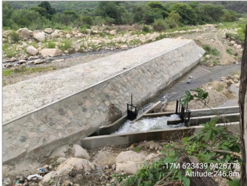
Figura 17: Dique de mampostería en riberas del río Chalaco
