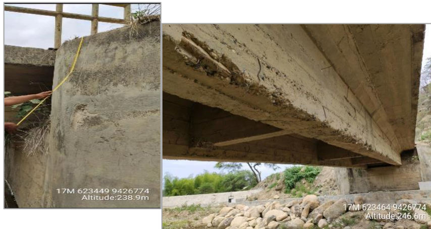
Figura 15: Estado de estructuras del Puente Chalaco
