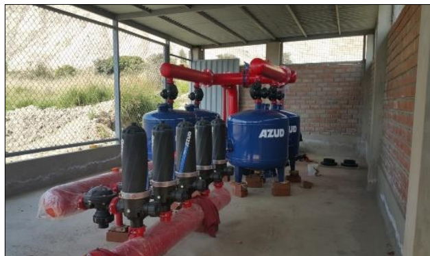
Figura 19: Instalación de Manifold y Sistema de Filtrado
