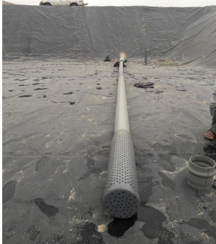
Figura 45: Instalación de succión de reservorio
