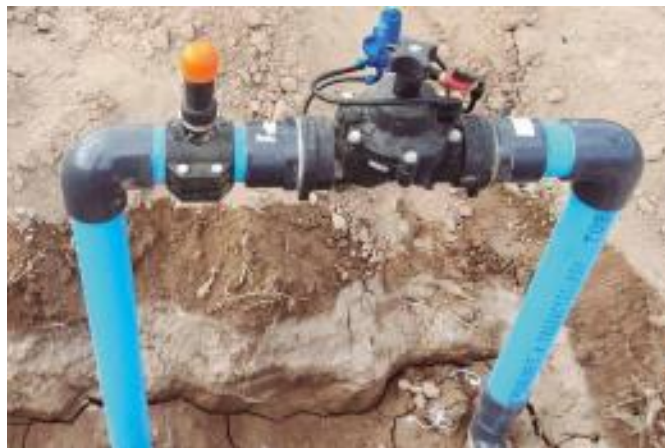
Figura 10: Cabezal de campo compuesto por válvulas hidráulicas
