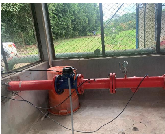
Figura 35: Medidor de caudal tipo woltman ubicado en la caseta de riego
